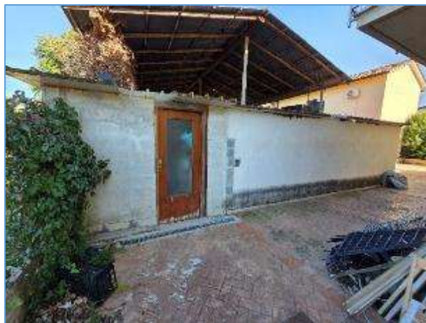
Figura 13 - Dettaglio locale esterno abusivo
