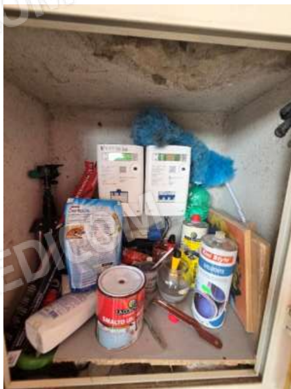
Figura 85 - Quadri elettrici esterni
