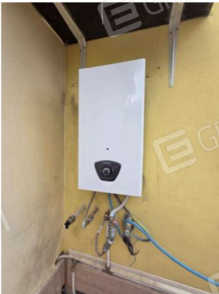
Figura 43 - Scaldino esterno u.i. piano terra
