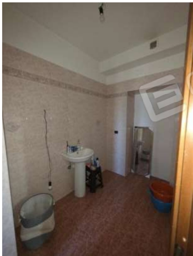
Figura 29 - Bagno 1 u.i. piano terra
