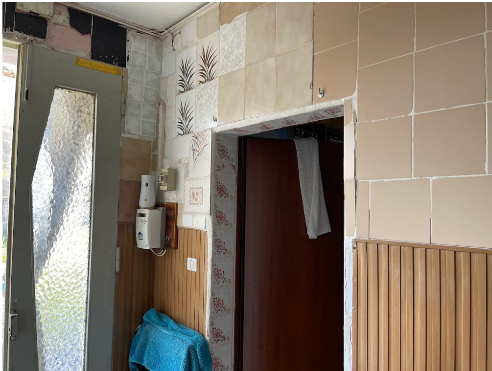
Estrema povertà delle finiture, zona ingresso.
