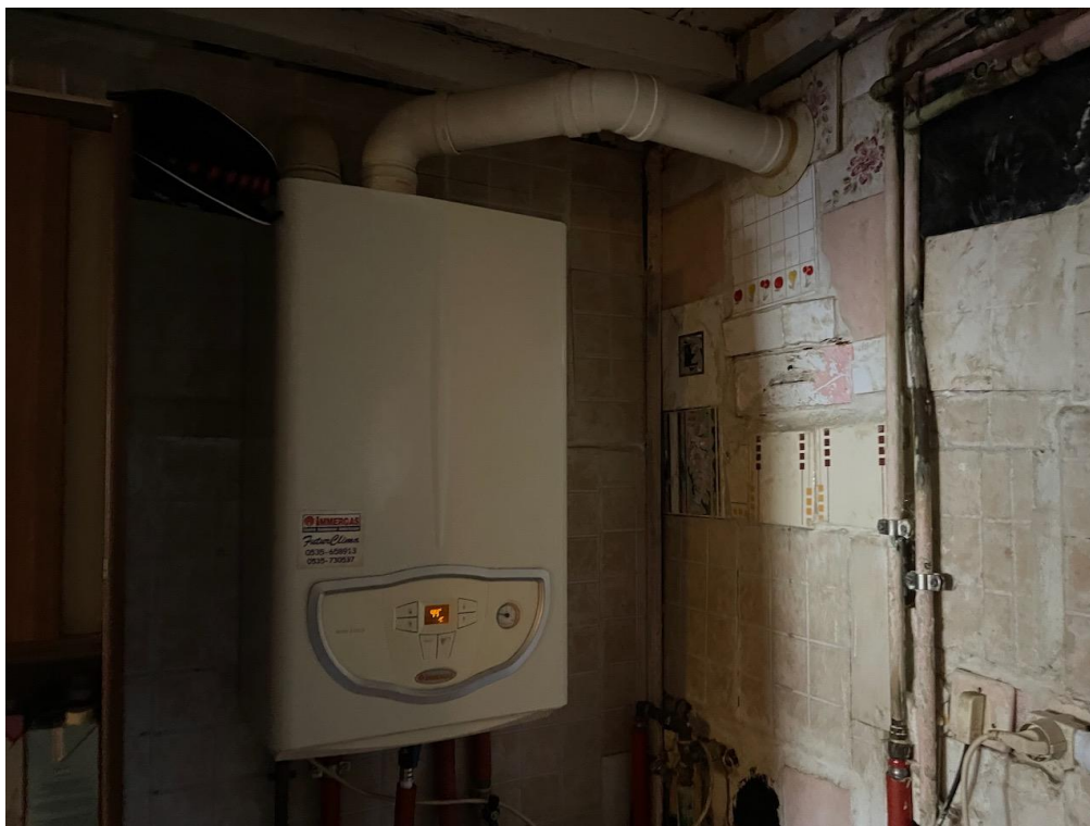
Caldaia posta in cucina
