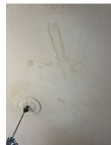
Foto n. 28 - Cucina - particolare delle macchie a soffitto
