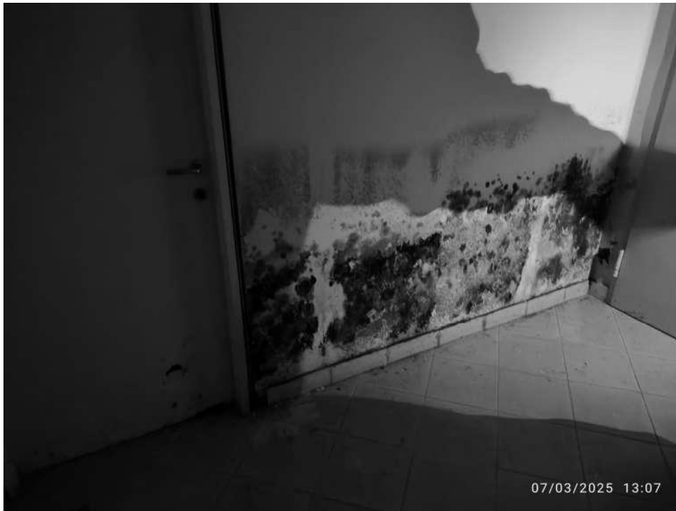
Foto n° 11: Segni di umidità di risalita e muffa in alcune pareti del piano seminterrato condominiale
