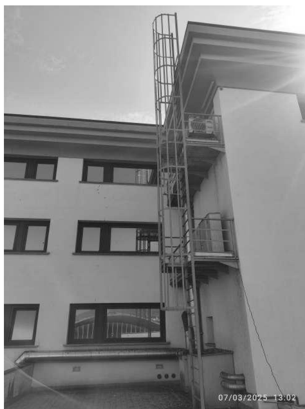
Foto n° 16: Terrazzo condominiale al piano primo per posizionamento impianti con scala in ferro del tipo alla marinara per l'accesso alla copertura e con due passerelle per la manutenzione degli impianti
