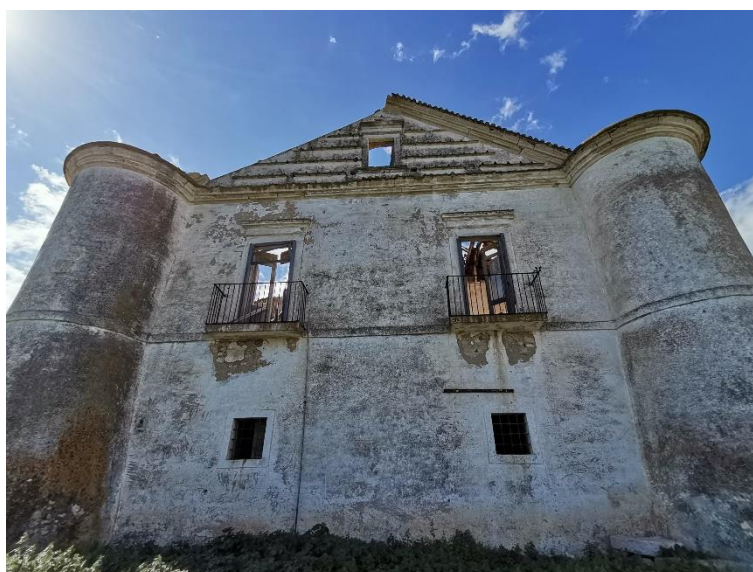
Dai balconi si vede la mancanza di parte della copertura del tetto
