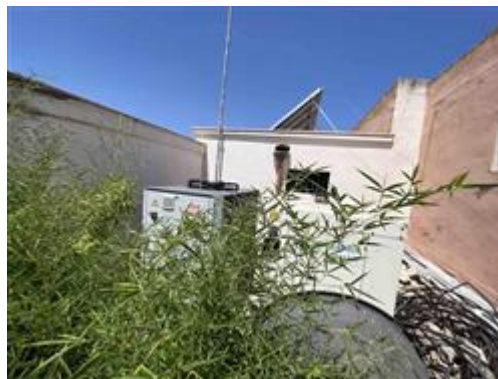
Il gruppo elettrogeno e la pompa di calore visibili dal giardino botanico
