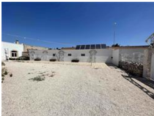
I pannelli solari visibili dal piazzale antistante l'agriturismo
