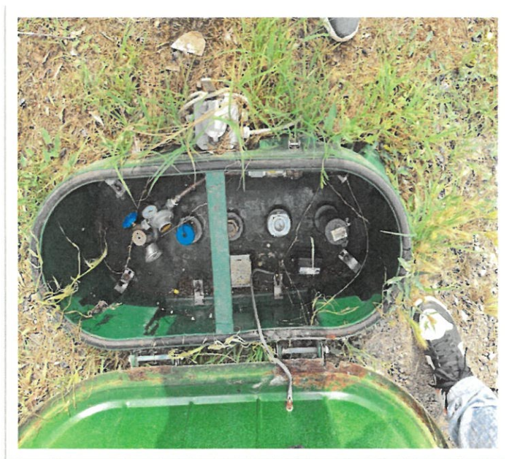
SERBATOIO GAS ESTERNO INTERRATO IN COMUNE CON ALTRA PROPRIETA'
