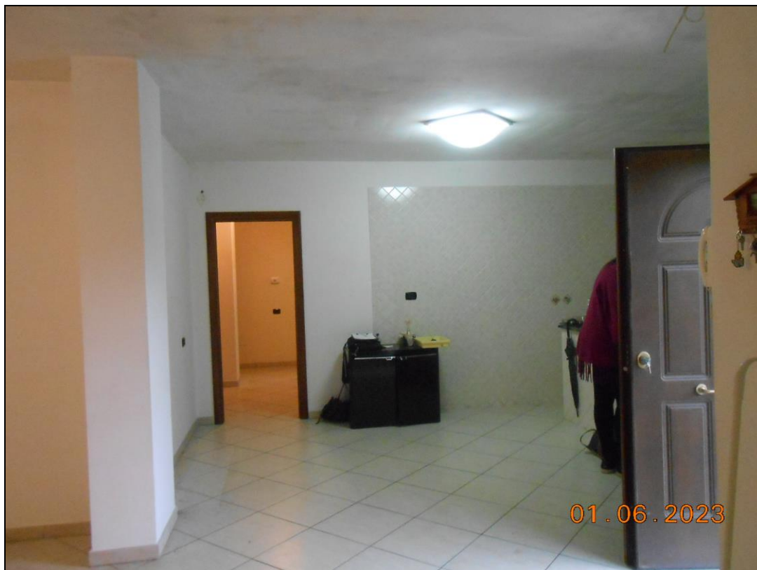
FOTO N. 19 Vista interna dell'immobile. Si notano le macchie di condensa sul soffitto.
