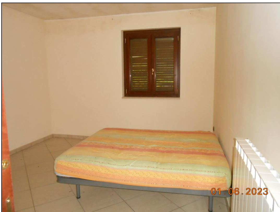
FOTO N. 24 Vista interna dell'immobile. Si notano diffuse macchie di condensa e muffa sul soffitto e pareti.
