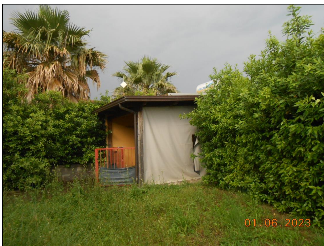
FOTO N. 10 Vista del box – gazebo dell'immobile. Si nota lo stato di abbandono.
