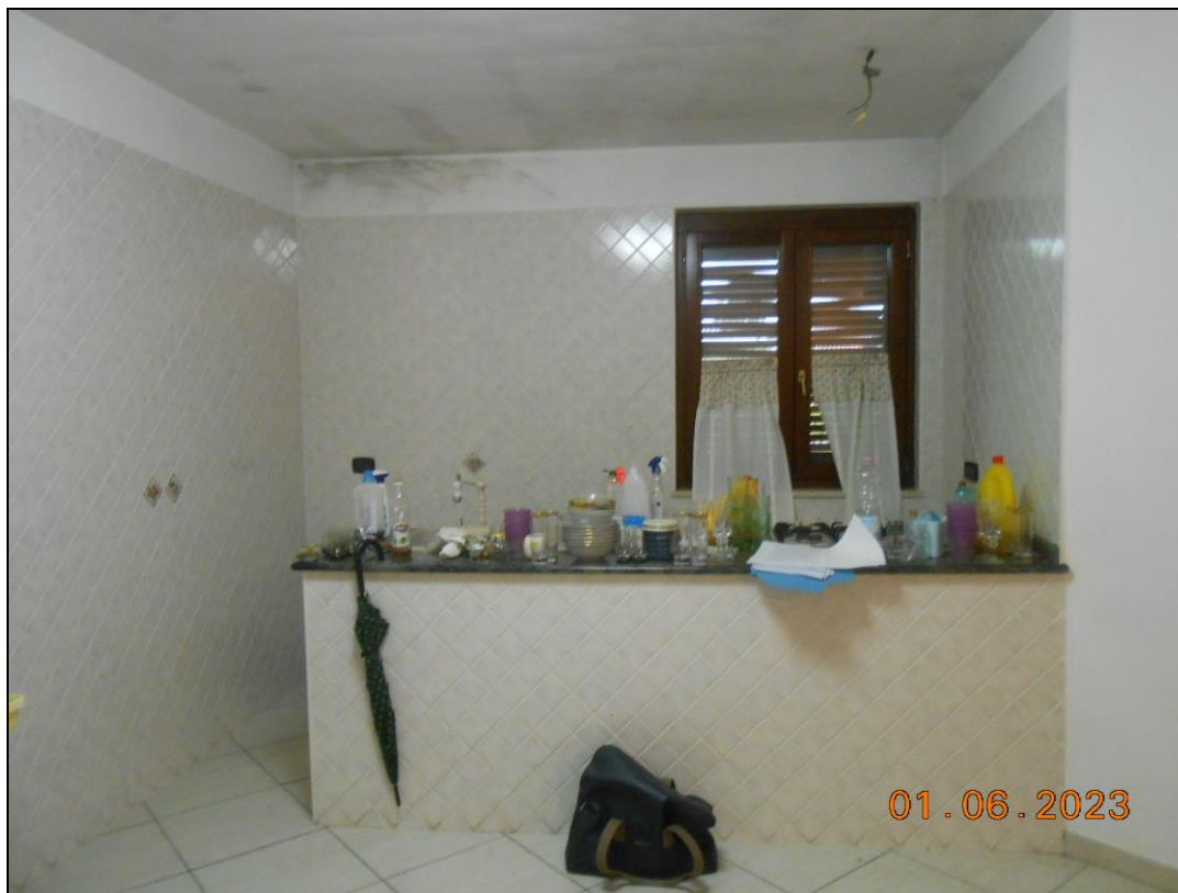
FOTO N. 21 Vista del vano cucina. Si notano macchie diffuse di condensa e muffa sul soffitto e pareti.
