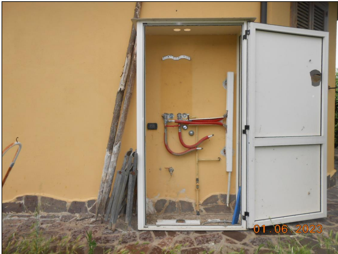
FOTO N. 15 Vista armadietto caldaia. Si nota la caldaia asportata.
