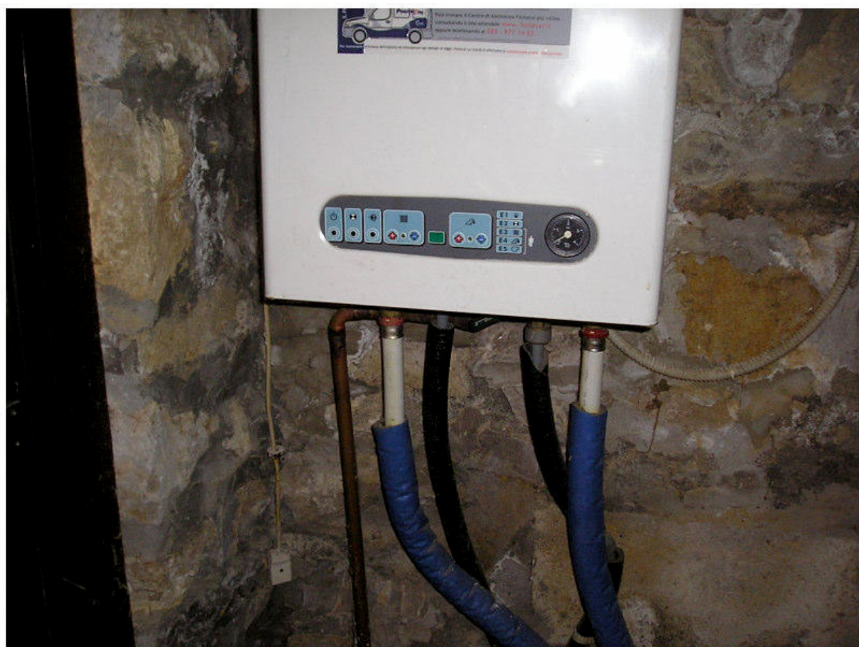
FOTOGRAFIA 34 - Piano Seminterrato / Nicchia Caldaia
