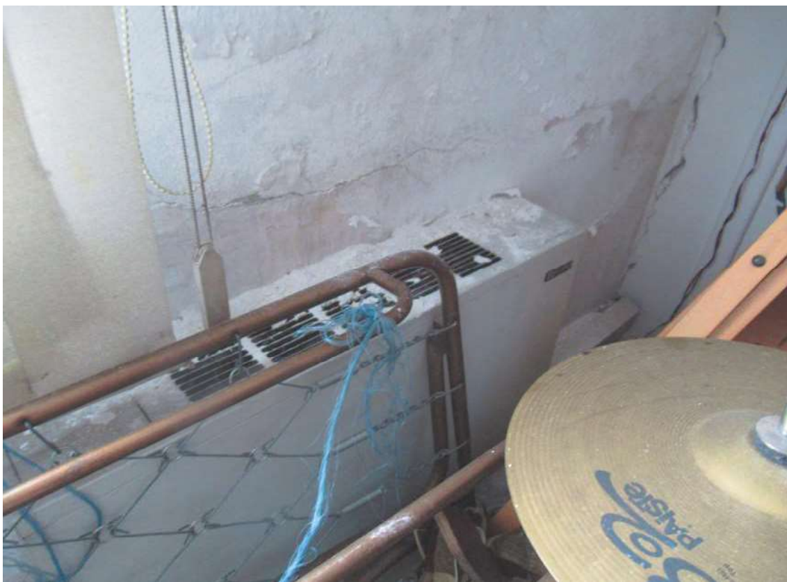
Foto 29: Infiltrazione in corrispondenza giunto corpi di fabbrica al primo piano
