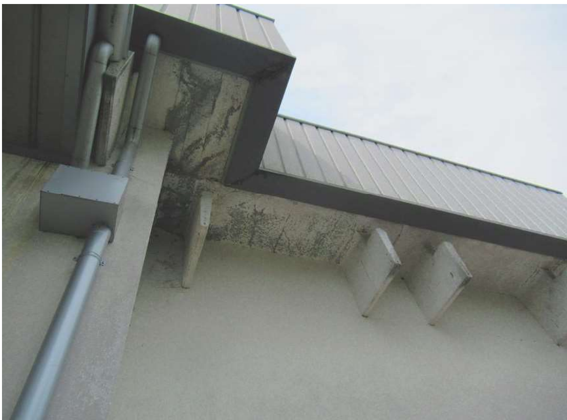
Foto 9: Infiltrazione a Nord
