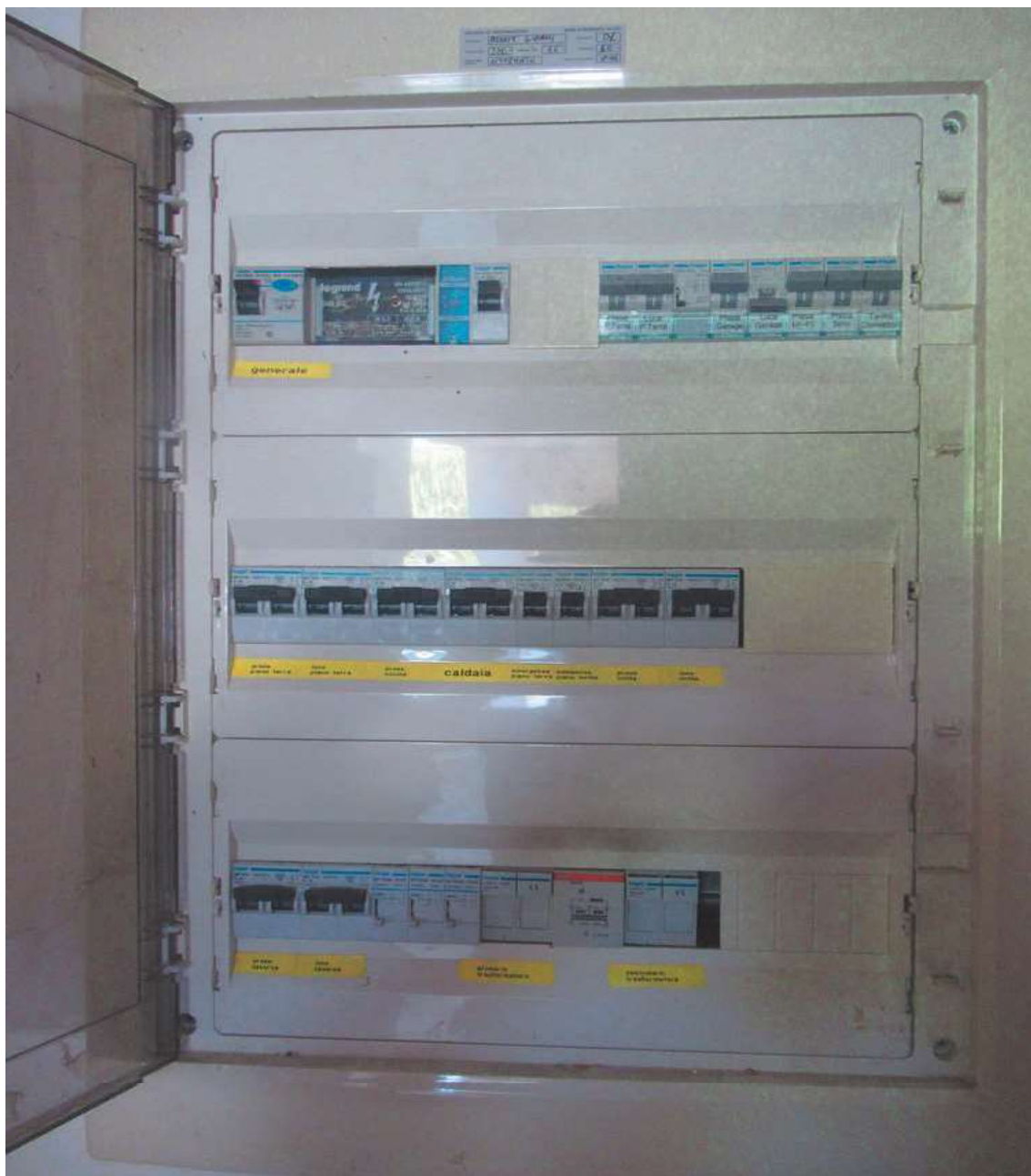
Foto 25 : Quadro elettrico nel disimpegno
