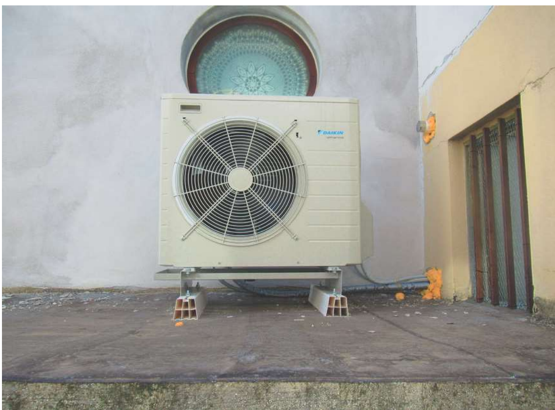
Foto 6: Unità esterna pompa di calore
