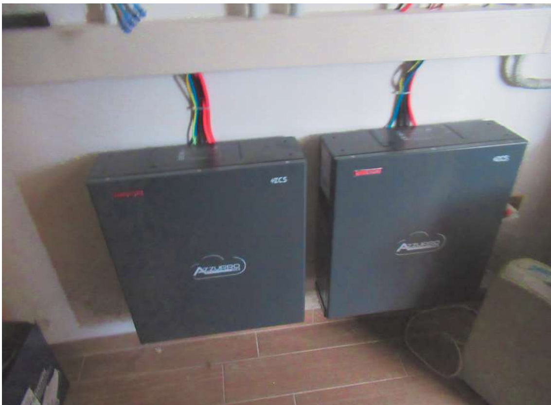
Foto 24: Batterie di accumulo fotovoltaico installate nel deposito
