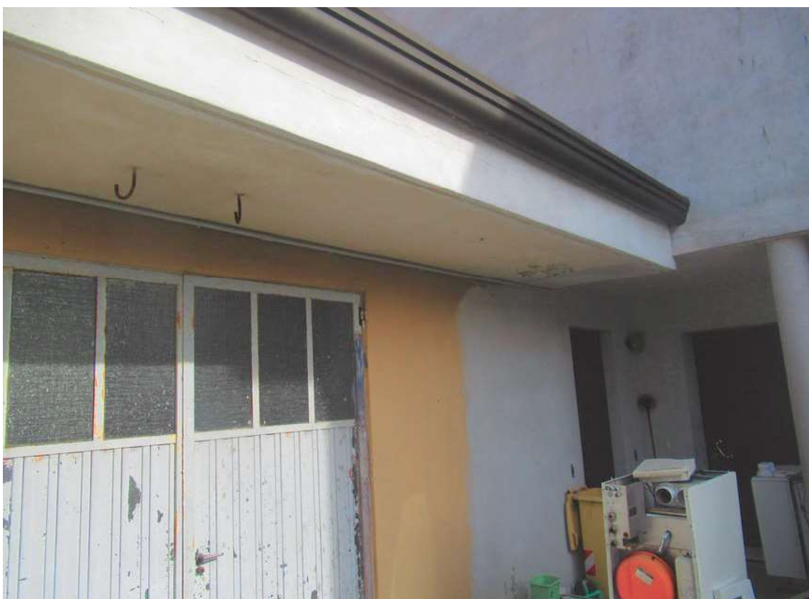
Foto 14: Particolare collegamento fotovoltaico
