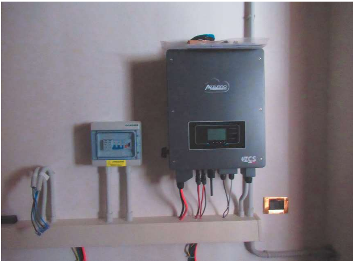
Foto 23: Inverter fotovoltaico installato nel deposito
