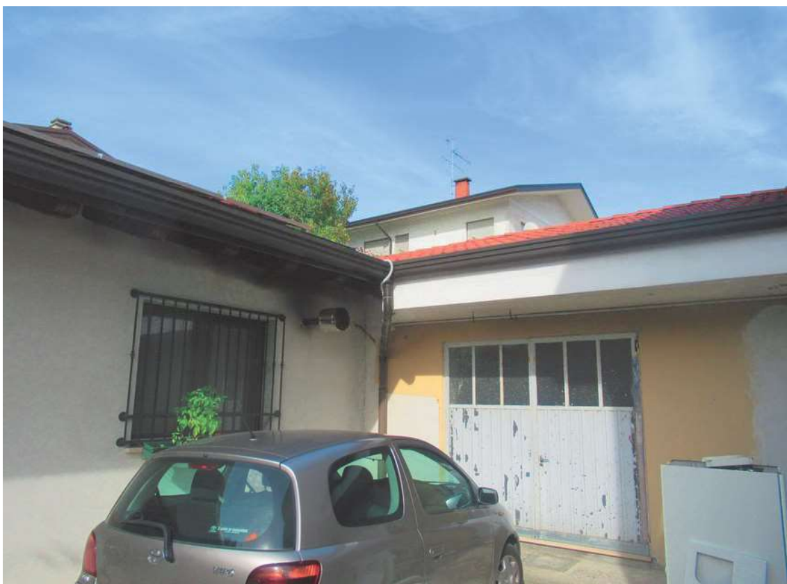
Foto 13: Collegamento fotovoltaico installato dal fabbricato sul mapp. 325 all'abitazione
