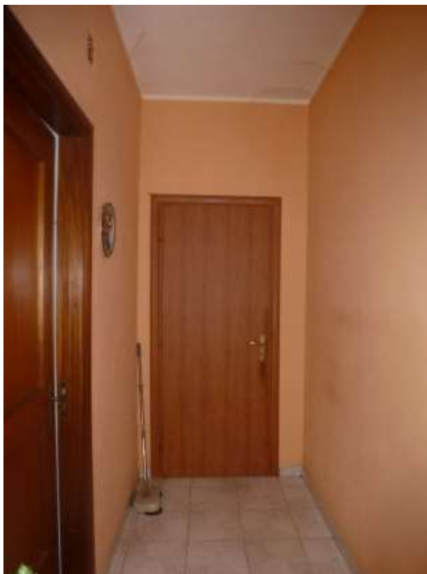
Foto n. 16 – Porta realizzata nel corridoio al posto della finestra prevista in progetto
