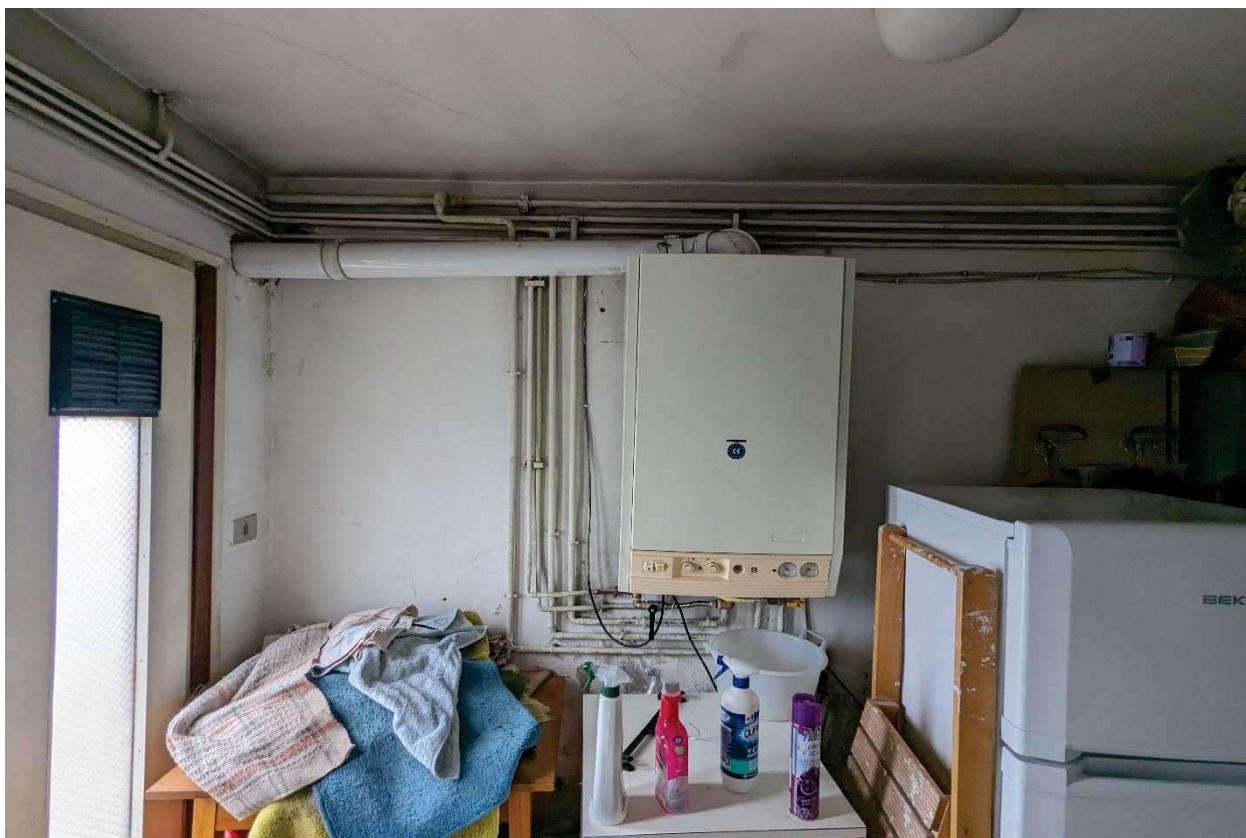
Foto n. 31 – Caldaia a gas murale, posta nel disimpegno al piano terra.
