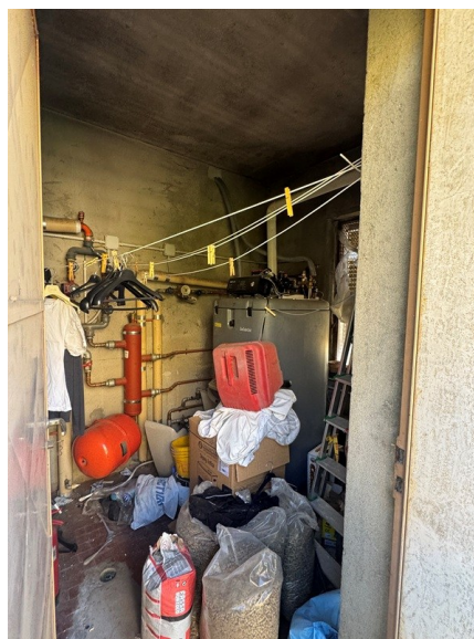
Vista locale caldaia comune
