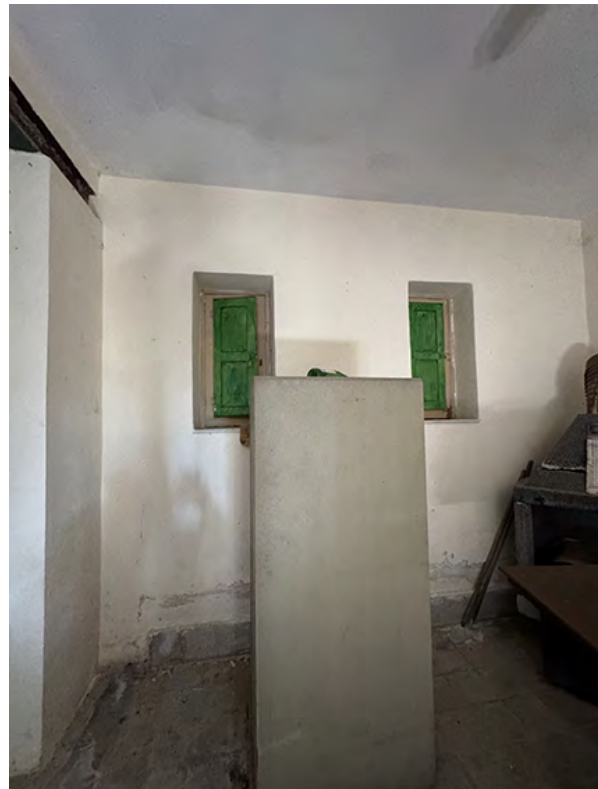
FOTO 8 - Aperture su cavedio esterno
