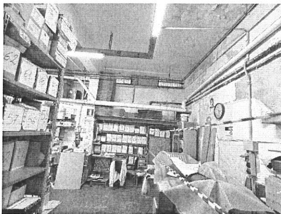
Fig. 24. Parete confinante con terrapieno, interessata da lesioni.
