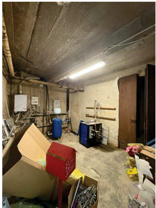
Centrale termica in cantina
