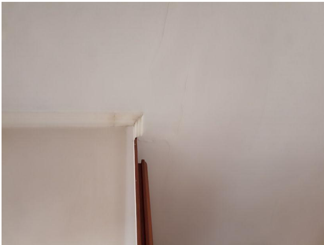
Foto 12 – infiltrazioni dalla copertura
