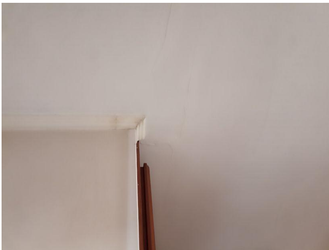
Foto 12 – infiltrazioni dalla copertura
