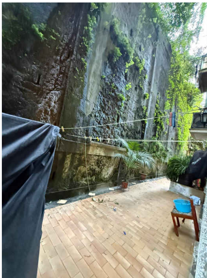
Foto n.30- Muro di contenimento oggetto di messa in sicurezza ripreso dalla finestra della camera.
