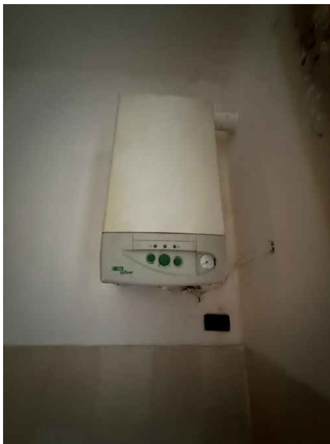
Foto n.19- Caldaia in cucina.
