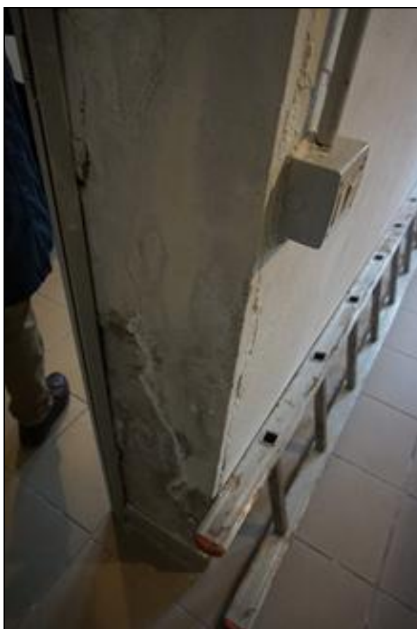
FOTO 40 – Piano interrato – Porta di collegamento tra i due garage e particolare umidità risalita
