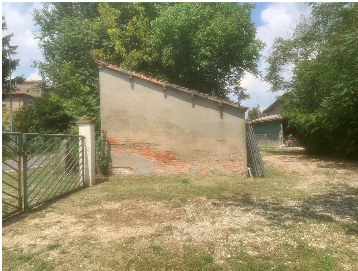
FOTO 3 VIA BASSA ZONA GARAGE
