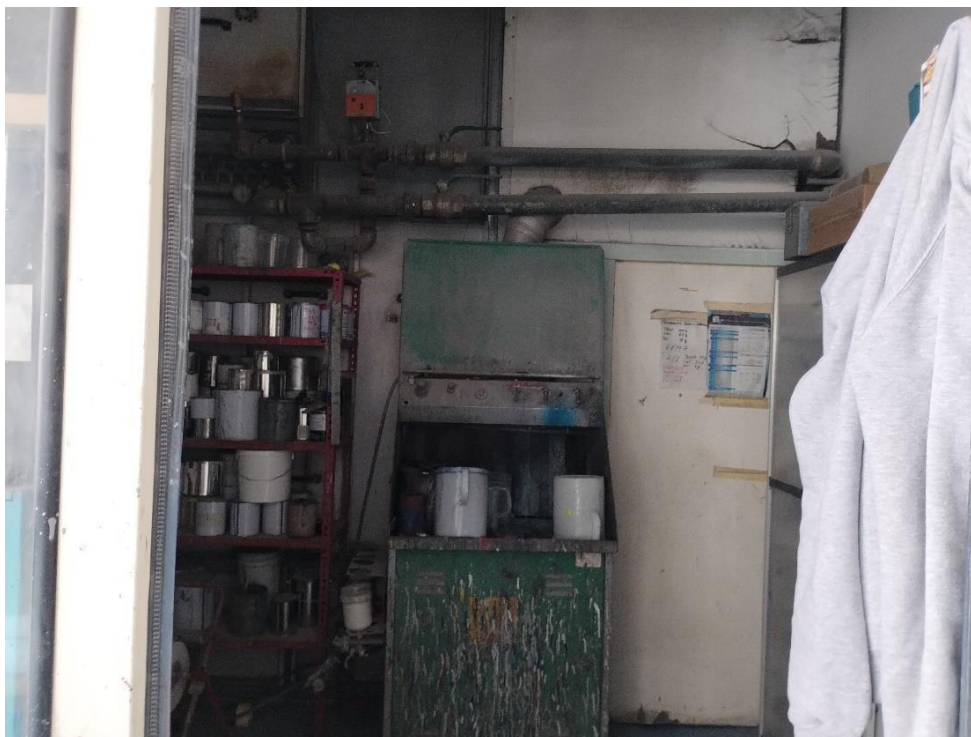
FOTO 7: PART. 377 PORZIONE AMPLIAMENTO NON AUTORIZZATO
