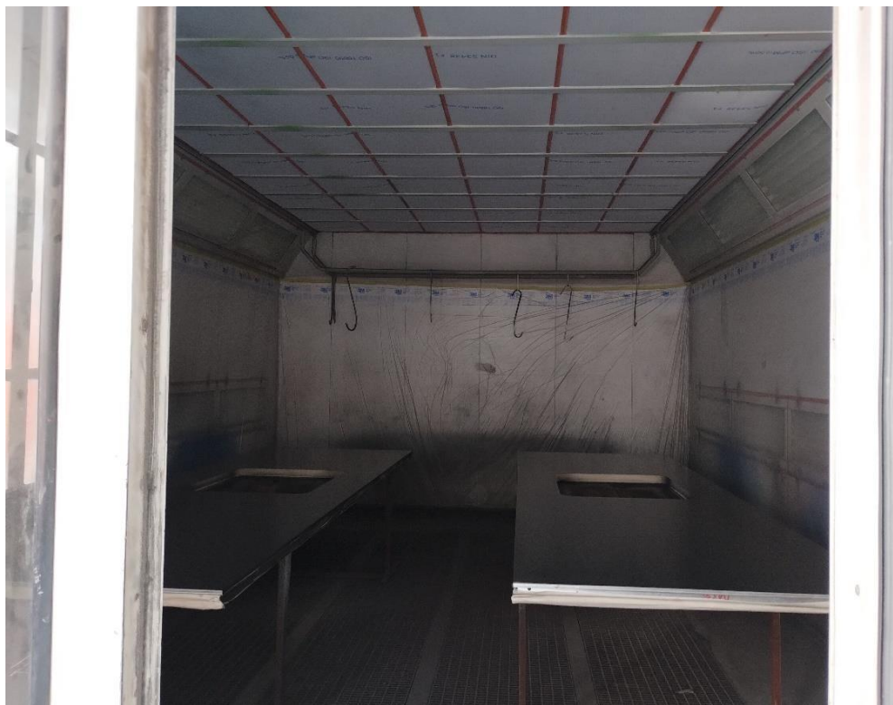
FOTO 6: PART. 377 PORZIONE AMPLIAMENTO NON AUTORIZZATO
