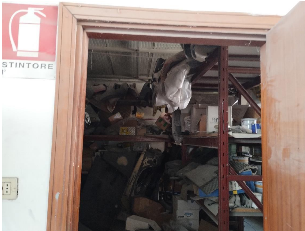
FOTO 8: PART. 377 LOCALE DEPOSITO AMPLIAMENTO NON AUTORIZZATO
