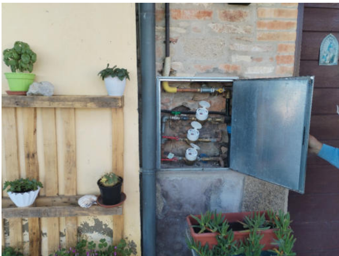
Foto n° 37 : contatori impianto idrico delle unità immobiliari censite al C.F. nel foglio n° 39 con le particelle n° 11/12-473/3(graffata) e n° 11/11-473/2(graffata)
