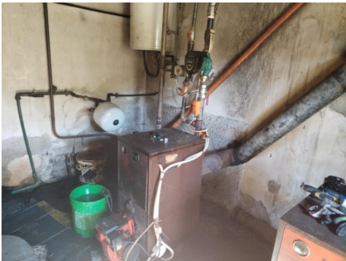
Foto n° 38 : centrale termica comune (C.F. foglio n° 39 particella 11/10 ) alle unità immobiliari censite al C.F. nel foglio n° 39 con le particelle n° 11/12-473/3(graффata) e n° 11/11-473/2(graффata)
