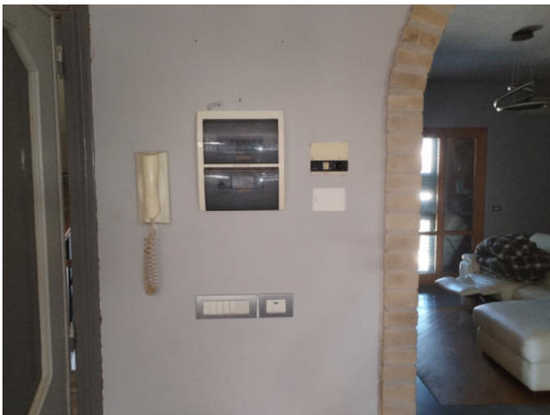
Foto n° 35 : interno dell'unità immobiliare censita al C.F. nel foglio n° 39 con la particella n° 11/12-473/3(graftata) – quadro elettrico e termostato impianto termico
