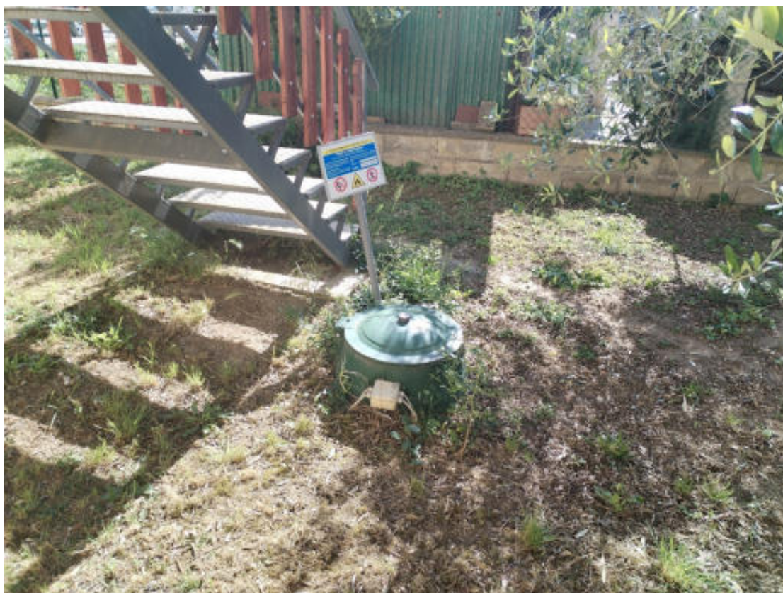
Foto n° 39 : bombolone GPL comune alle unità immobiliari censite al C.F. nel foglio n° 39 con le particelle n° 11/12-473/3(graффata) e n° 11/11-473/2(graффata)
