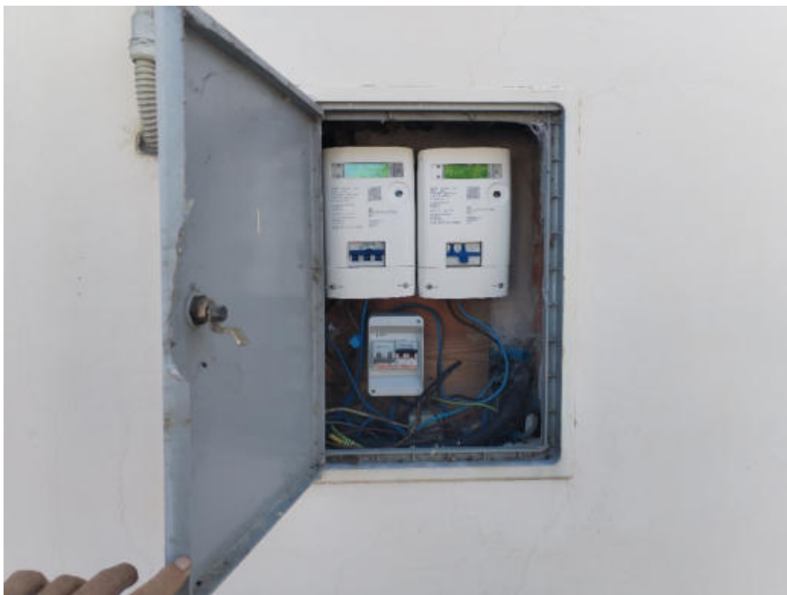
Foto n° 36 : contatori energia elettrica delle unità immobiliari censite al C.F. nel foglio n° 39 con le particelle n° 11/12-473/3(graffata) e n° 11/11-473/2(graffata)
