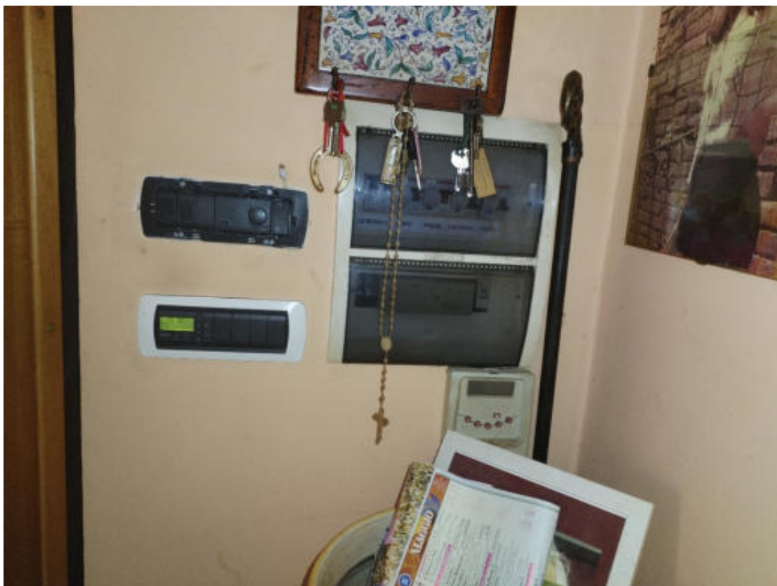
Foto n° 34 : interno dell'unità immobiliare censita al C.F. nel foglio n° 39 con la particella n° 11/11-473/2(graftata) – quadro elettrico e termostato impianto termico
