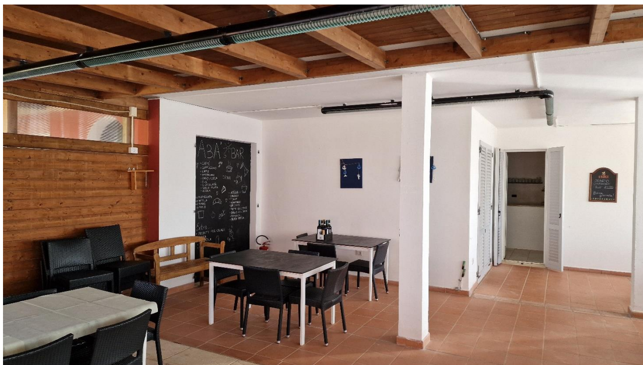
Fig. 6 – Palazzina rossa: interno veranda abusiva
