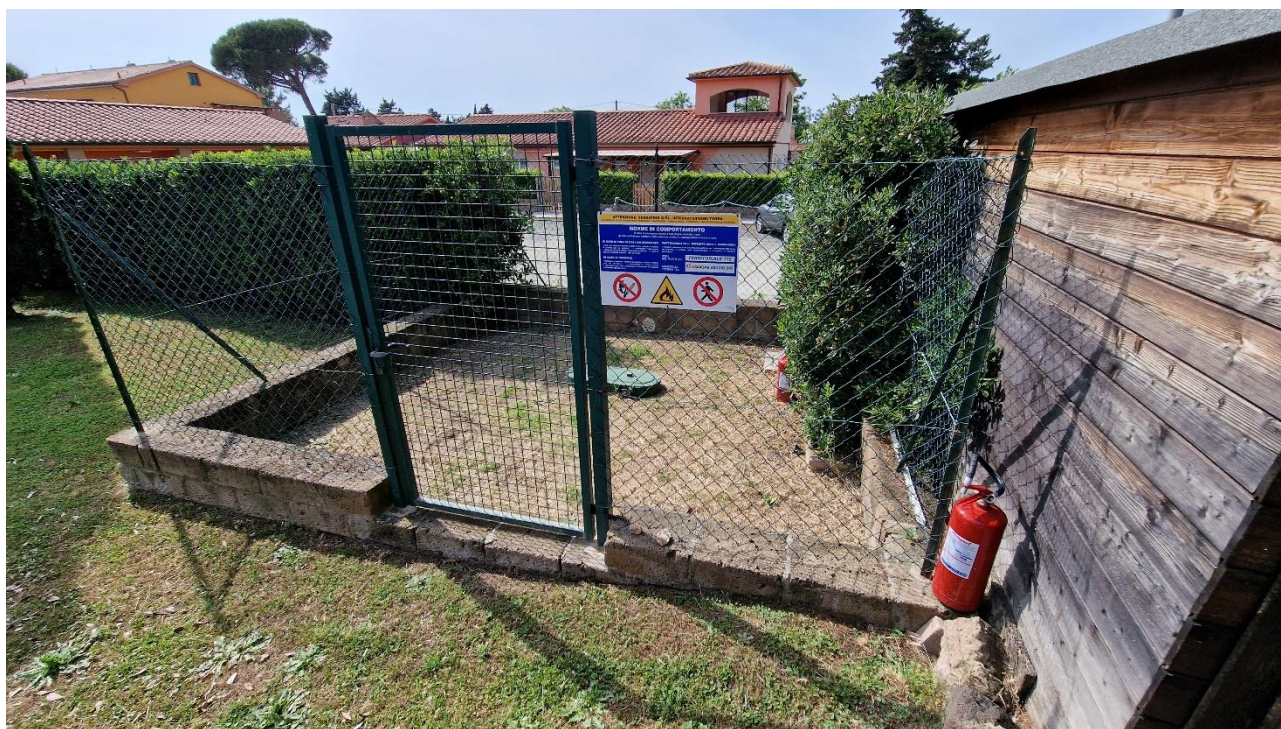
Fig. 30 – Serbatoio GPL interrato
