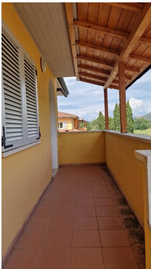
Fig. 26 – Esempio tettoie abusive su terrazzi
