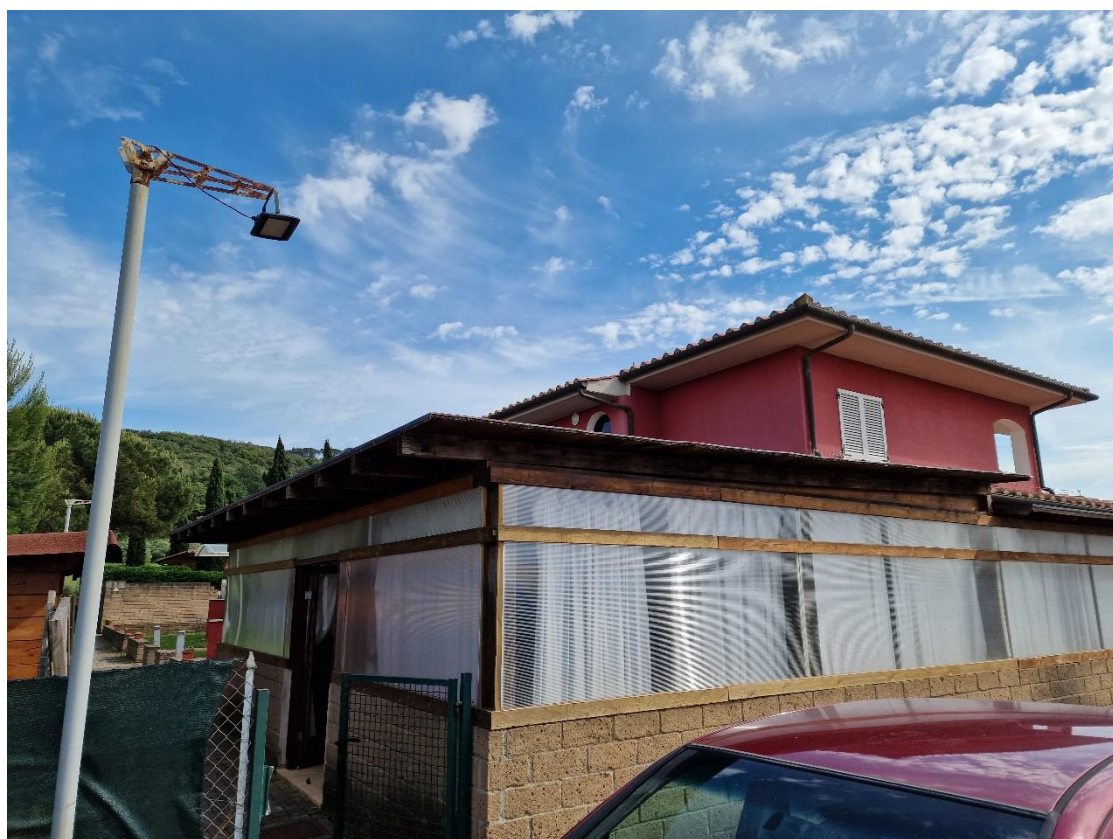
Fig. 4 – Palazzina rossa: la veranda abusiva
