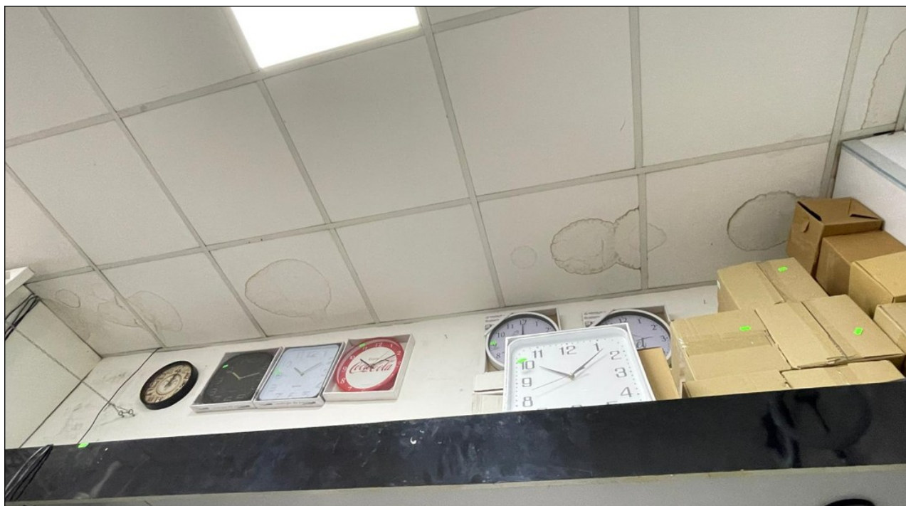
Controsoffitto: presenza di aloni scuri
