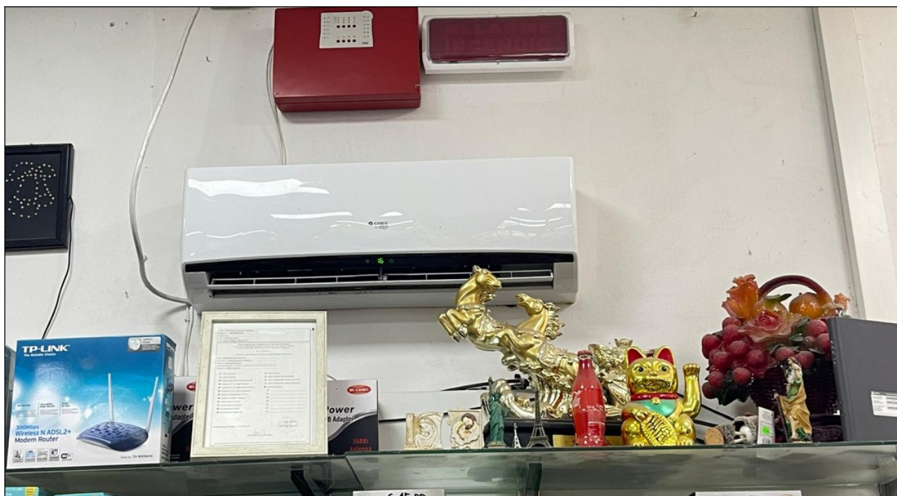
Split aria condizionata
