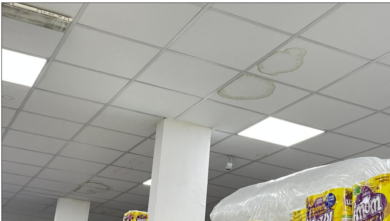
Controsoffitto: presenza di aloni scuri
