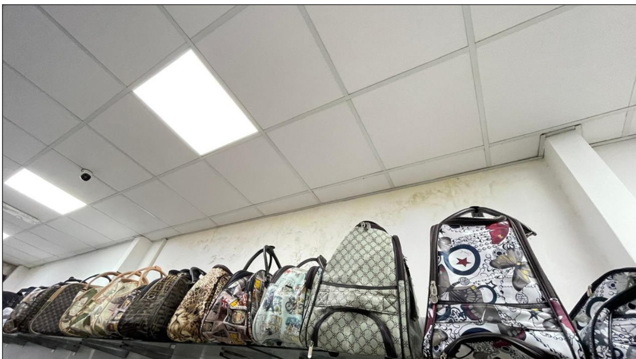
Parete sud: presenza di aloni scuri e sfogliamenti di pittura
