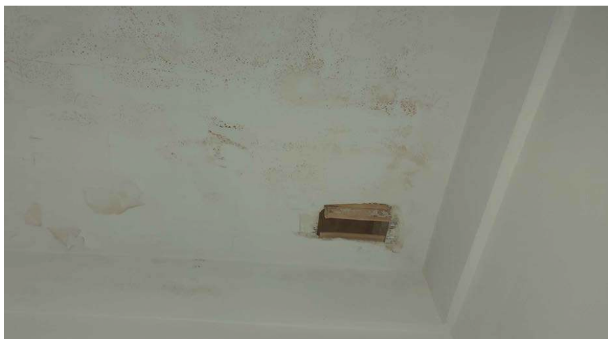
F.10a – Soffitto studio ammalorato
