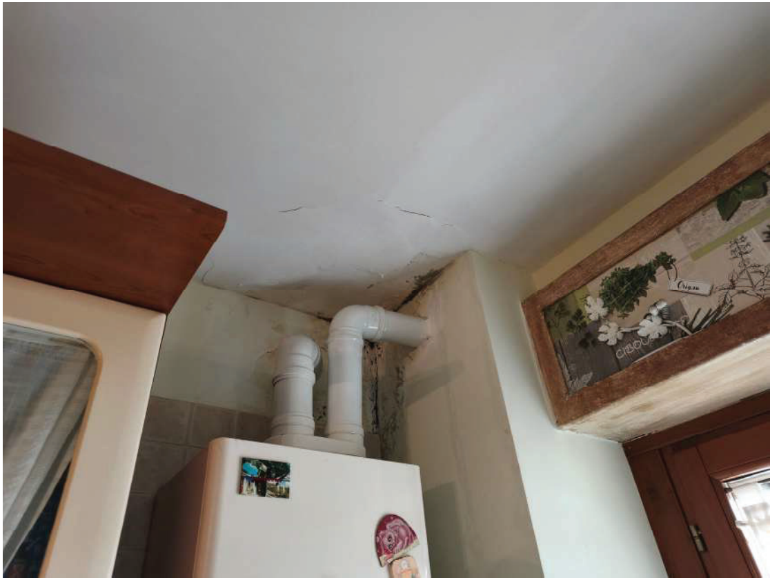
Foto n.9 (Zona infiltrativa piano secondo)
