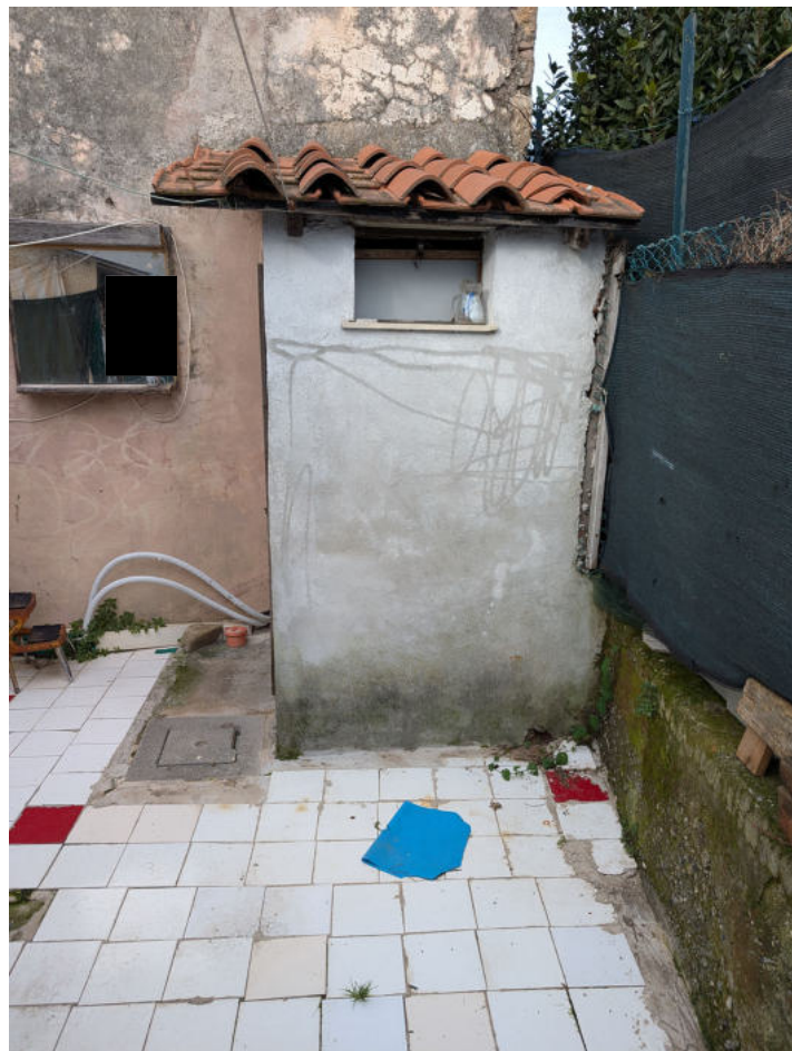
10 - Bagno esterno abusivo del mapp. 21 sub. 7
