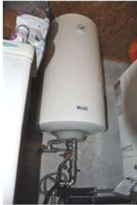
Foto 41 – impianto di riscaldamento e di produzione dell'acqua calda
