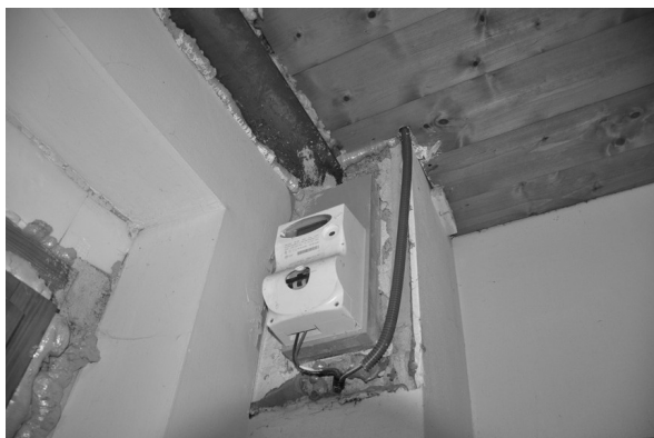
Foto 33 – Il contatore dell'energia elettrica nell'ingresso al piano terra
