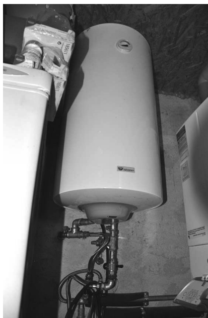
Foto 41 – impianto di riscaldamento e di produzione dell'acqua calda
