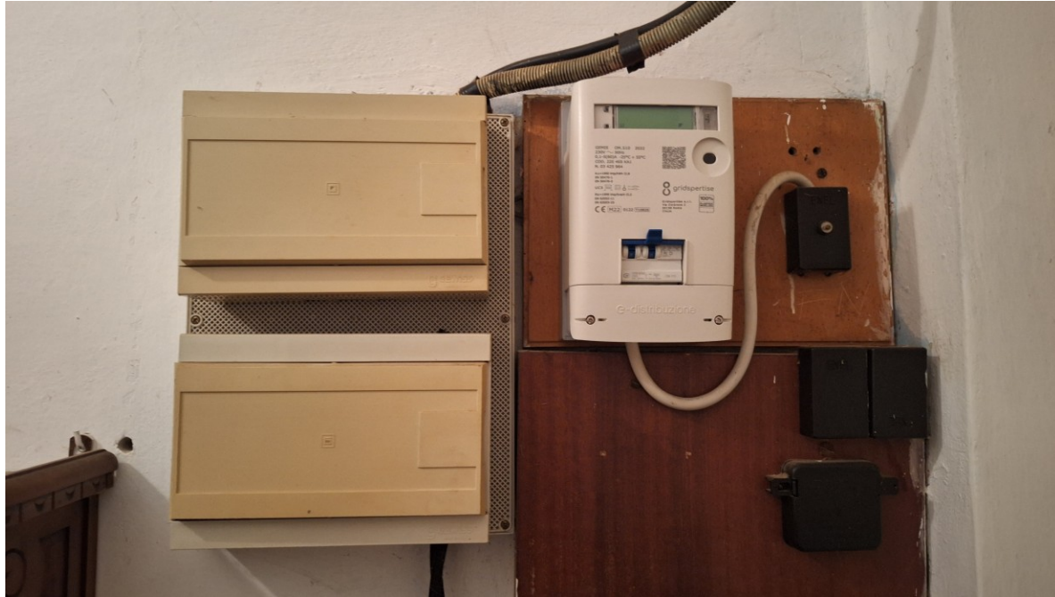
Contatore energia elettrica
