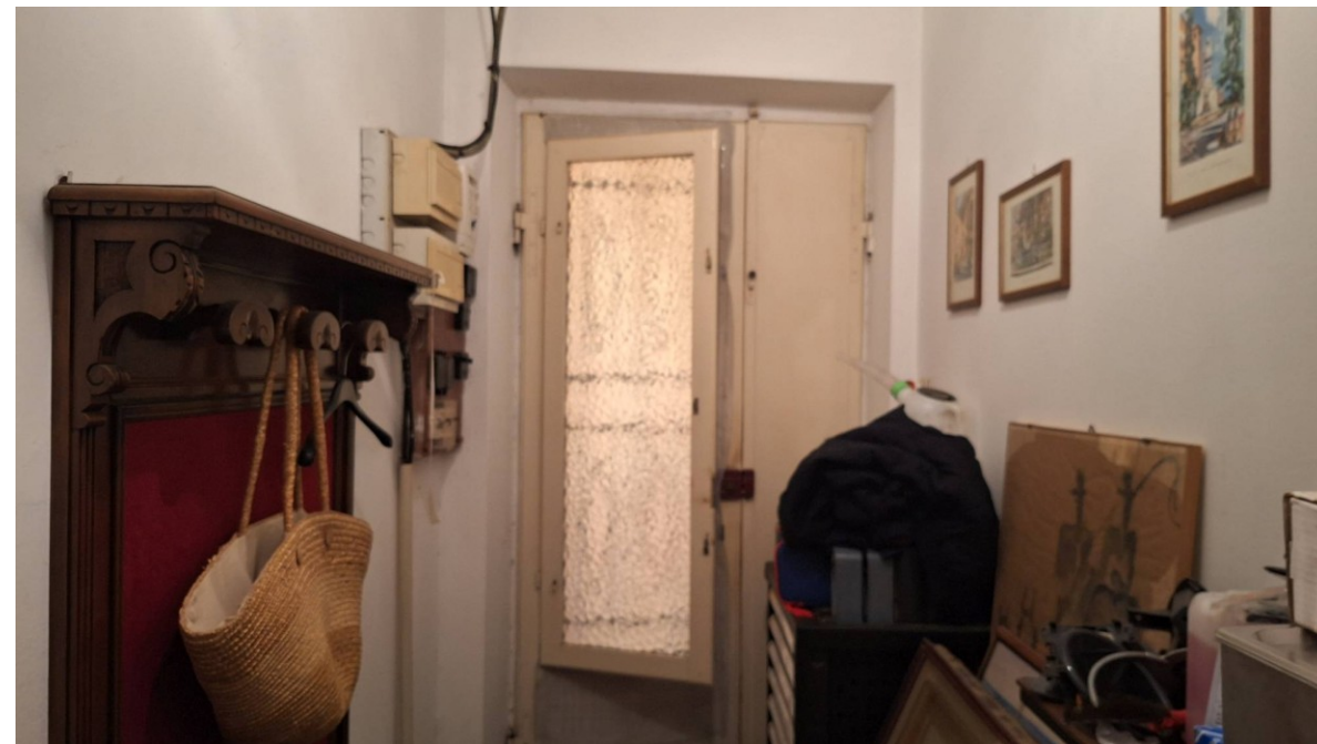
Contatore energia elettrica nel corridoio di altra u.i.
