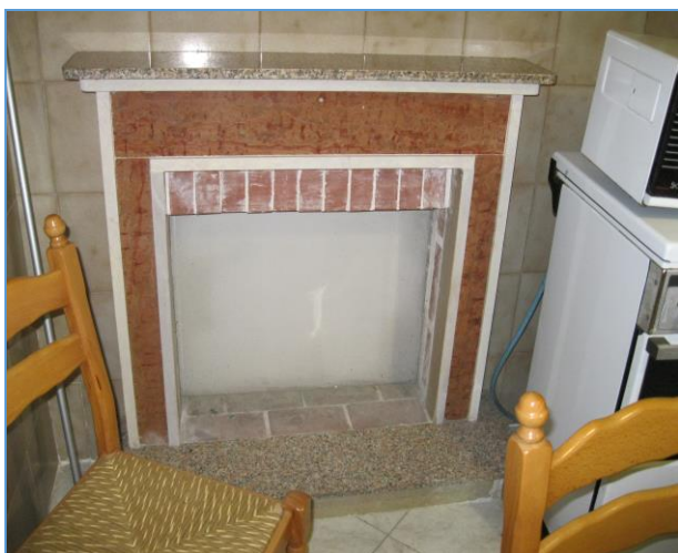
- Piano Primo: Camino presente in cucina -
