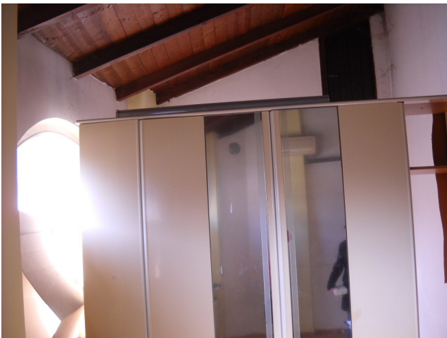
Soffitto piano primo
