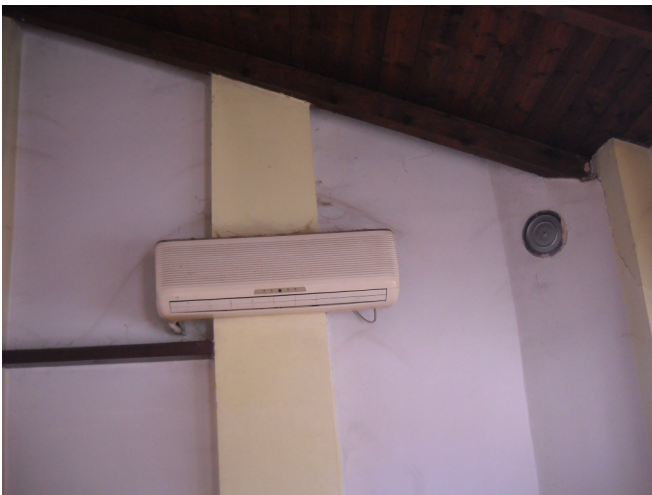
Pompa di calore piano primo
