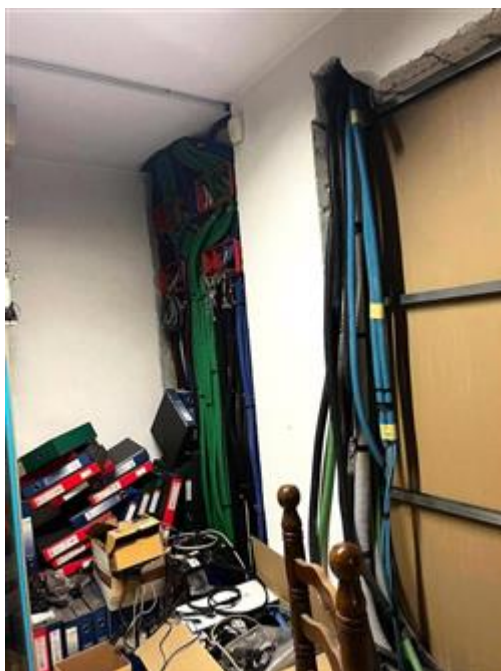
Vista interna del bene immobiliare e situazione impiantistica
