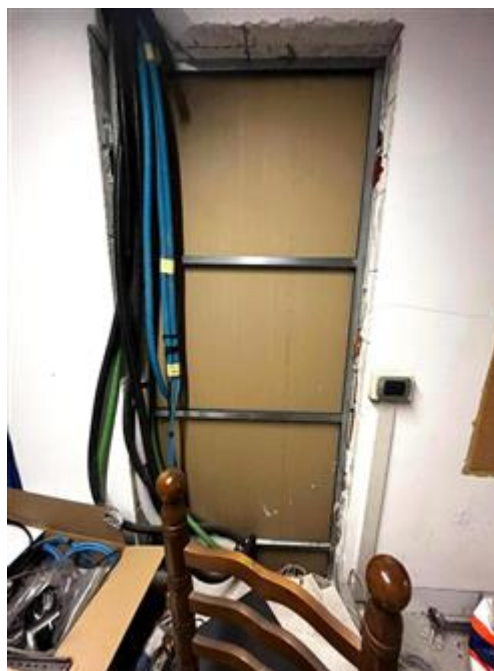
Particolare pannello di separazione in cartongesso e situazione impiantistica
