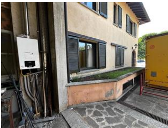
La caldaia, per il riscaldamento, situata nel subalterno 4 (tettoia) di altra proprietà
