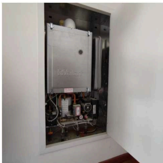
21- Particolare della nicchia con installata la caldaia
