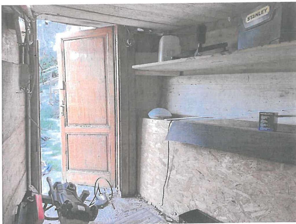
Foto 19: capanna di legno abusiva – accesso al resede frontale
