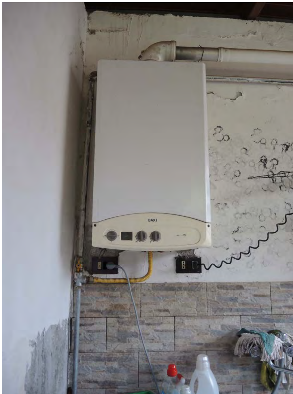
Foto 32: Particolare della caldaia a gas sulla parete del terrazzo.
