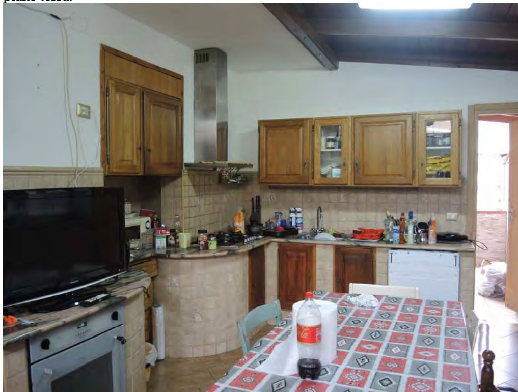
Foto 28: Vista interna del vano cucina ovvero dell'ampliamento realizzato in epoca successiva al 1994, non presente nella planimetria catastale. La foto ritrae sulla sx la chiusura della porta finestra sulla parete che, prima della realizzazione dell'ampliamento o in epoca antecedente al 1994, corrispondeva alla muratura esterna.
