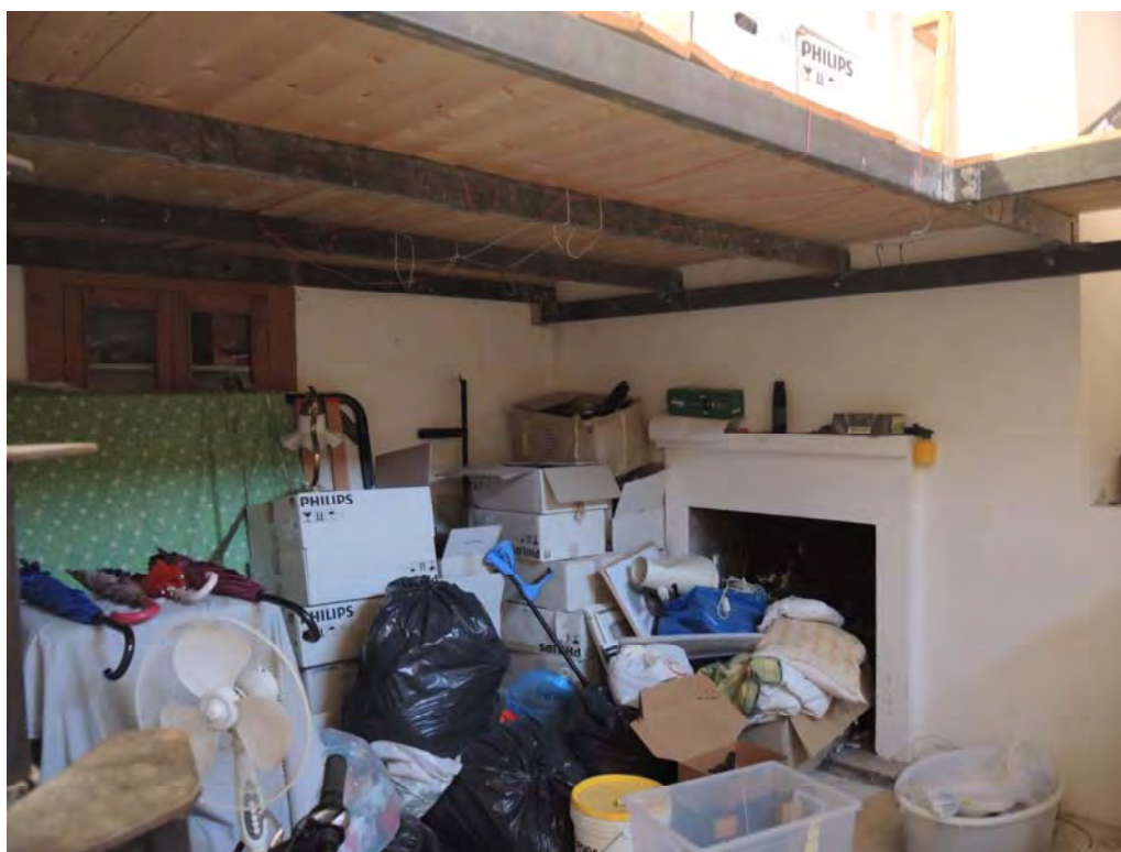
Foto 39: Vista interna del locale deposito al piano terra facente parte dell'unità immobiliare censita al foglio 5 part. 327 sub. 8 con particolare del soppalco, non presente nella planimetria catastale e realizzato in epoca successiva al 1994.
