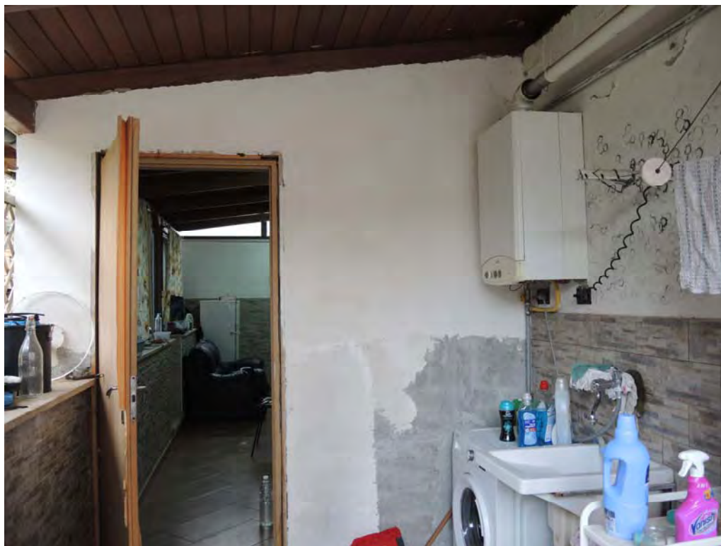
Foto 31: Vista interna del terrazzo adiacente alla cucina da cui si accede. La foto ritrae, sulla dx, la caldaia a gas dell'impianto termico.
