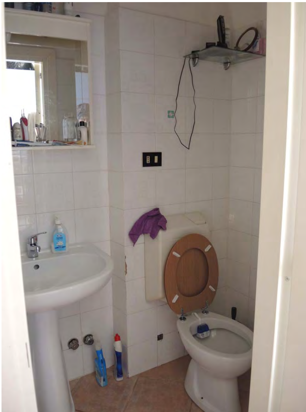
Foto 24: Vista interna del w.c. a servizio della camera 2 non presente nella planimetria catastale, realizzato in epoca successiva al 1994.
