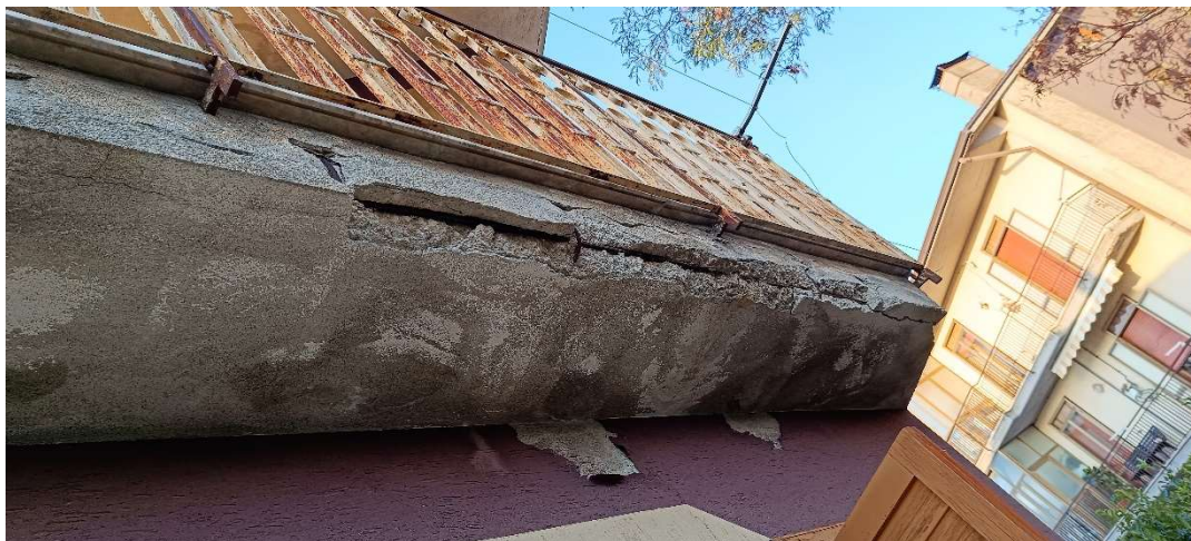
30 | Particolare degrado frontalini balcone lato Sud-Ovest
