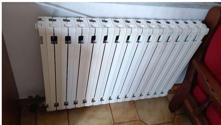
28 | Particolare radiatori in ghisa
