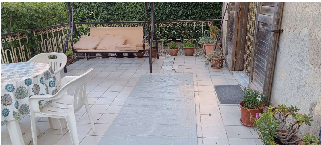
31 | Particolare guasti pavimentazione terrazza piano terra
