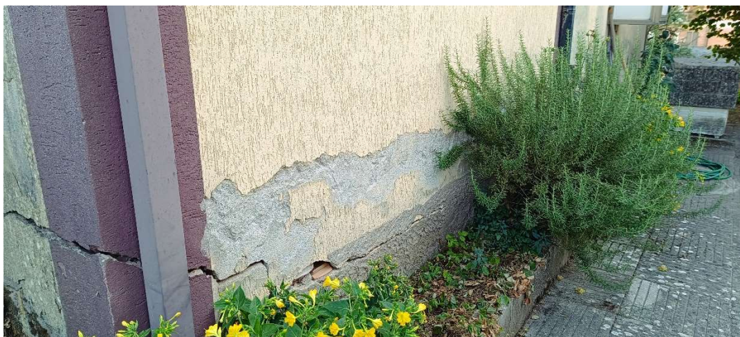
32 | Particolare cedimento muratura perimetrale cantina piano terra
