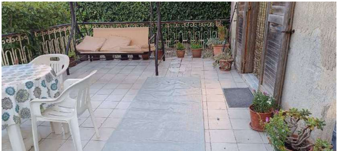
31 | Particolare guasti pavimentazione terrazza piano terra
