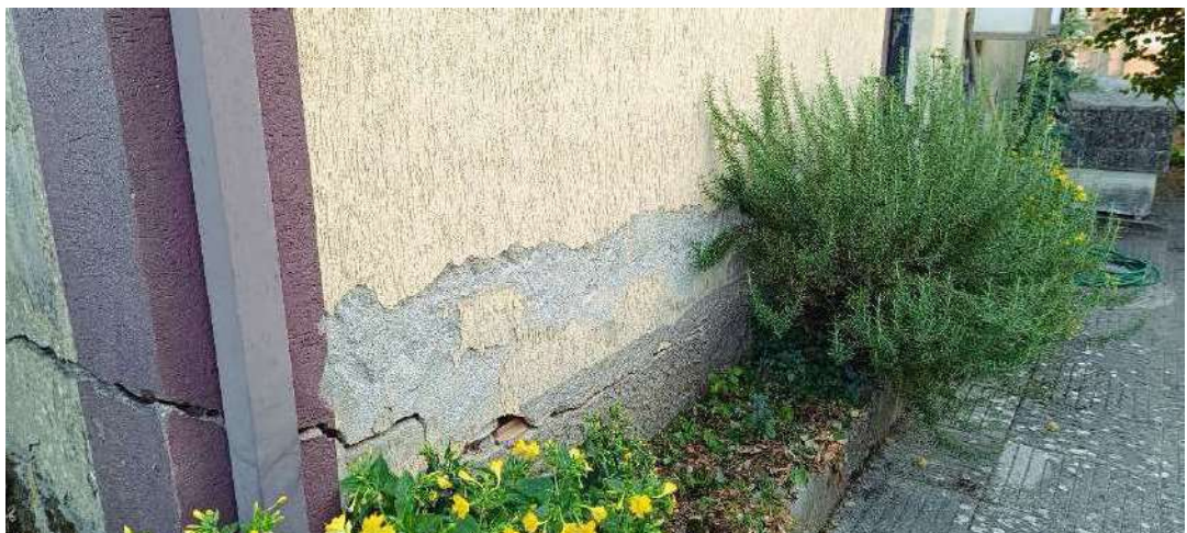
32 | Particolare cedimento muratura perimetrale cantina piano terra
