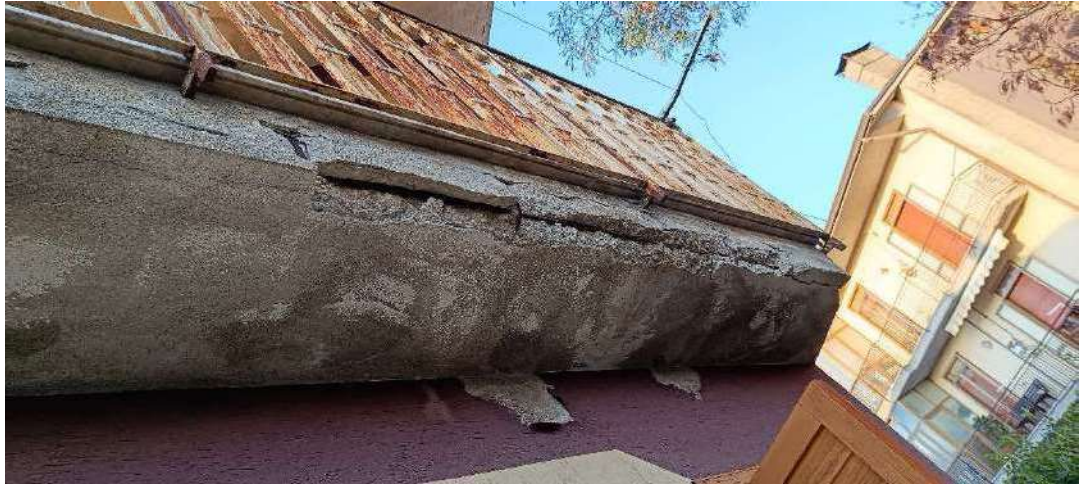
30 | Particolare degrado frontalini balcone lato Sud-Ovest
