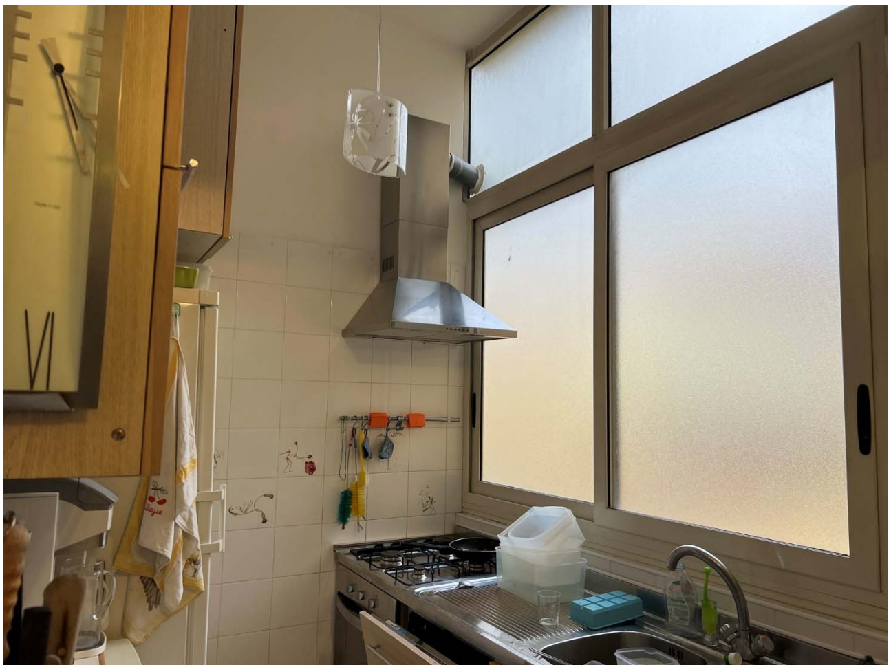
Foto 12 – Particolare della cucina
