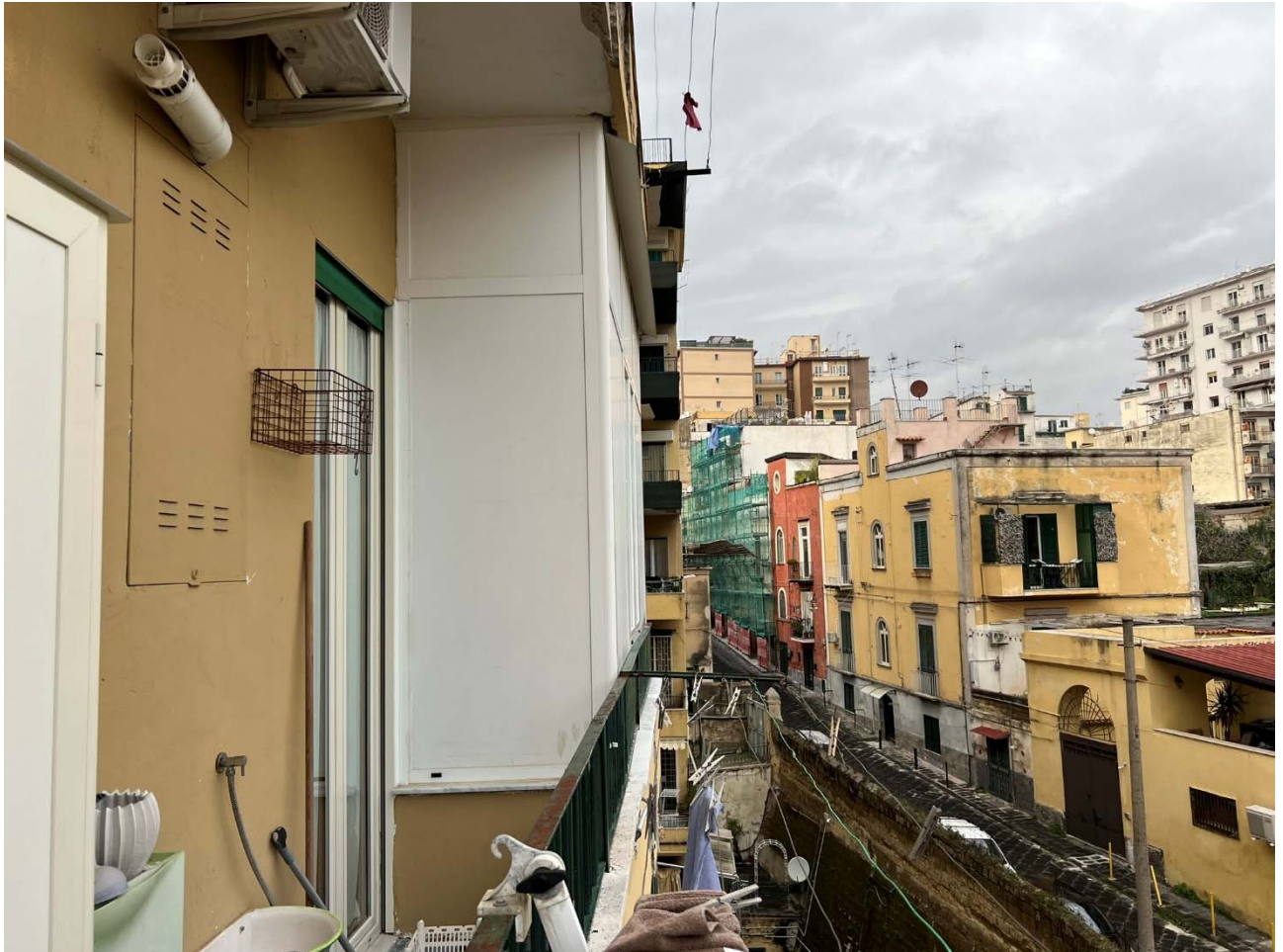
Foto 18 – Vista del balcone sul fronte est con evidenza della veranda (ampliamento camera da letto e bagno)
