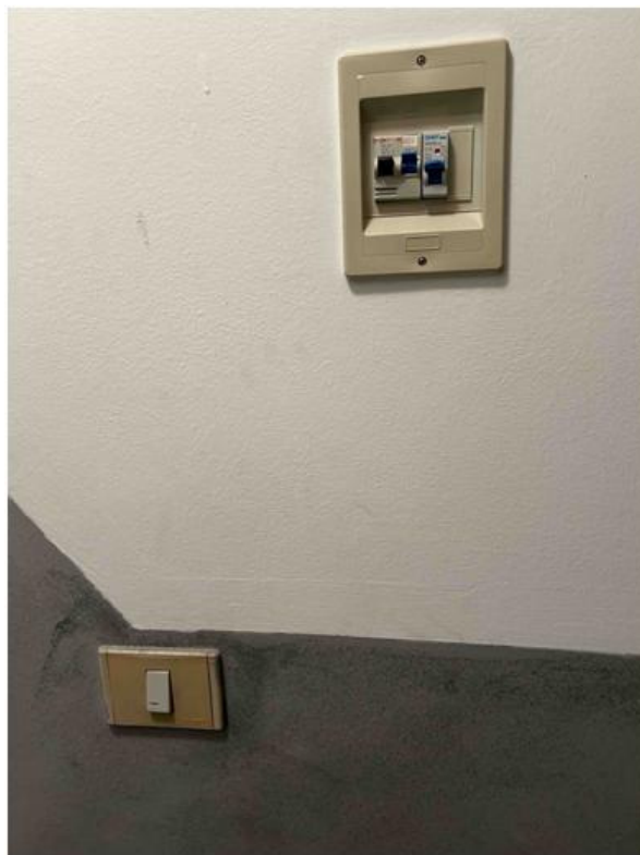
Foto n° 13 – Foto scattata all'interruttore elettrico generale posto all'ingresso del fabbricato, dotato di dispositivo magneto-termico (salva-vita).
