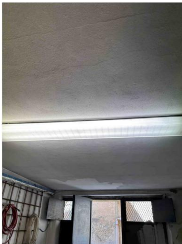
Foto n° 10 – Foto scattata al corpo illuminante posizionato sul soffitto del garage. L'impianto è realizzato sottotraccia.
