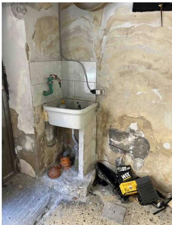
Foto n° 8 – Altra scattata all'interno del garage/box. All'interno vi è collocata una pilozza collegata alla rete idrica e fognaria. Si rilevano vistose tracce di umidità di risalita lungo la parete.
