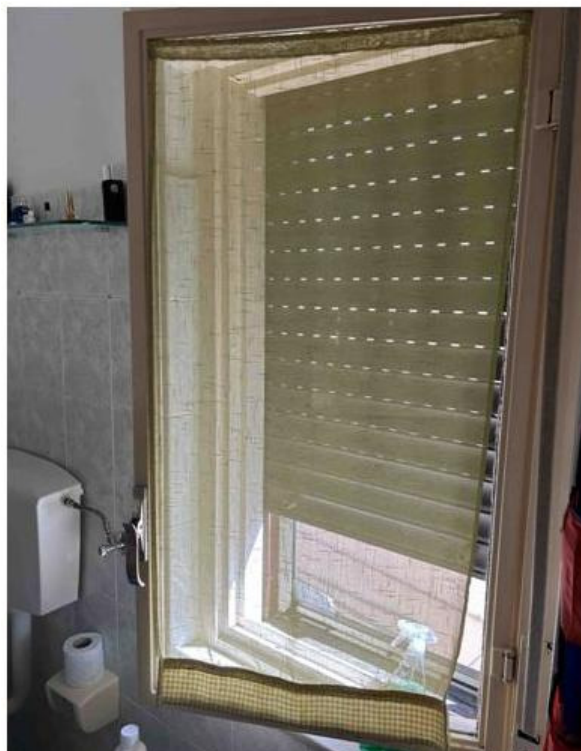
Foto n° 44 – Foto scattata alla finestra/infisso ad un'anta in lamiera. Mediocri le condizioni.
