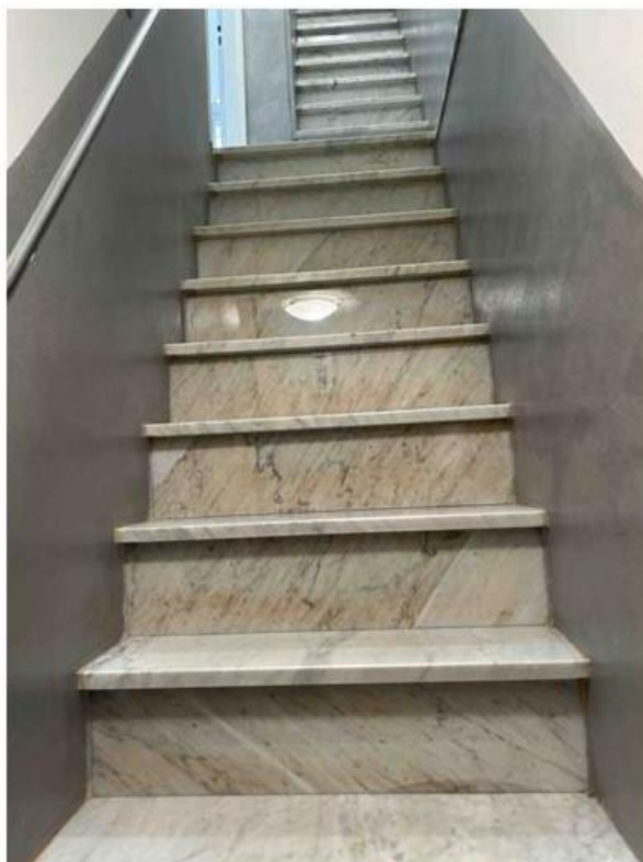
Foto n° 21 – Altra foto scattata alla prima rampa della scala interna che consente l'accesso ai piani superiori.
