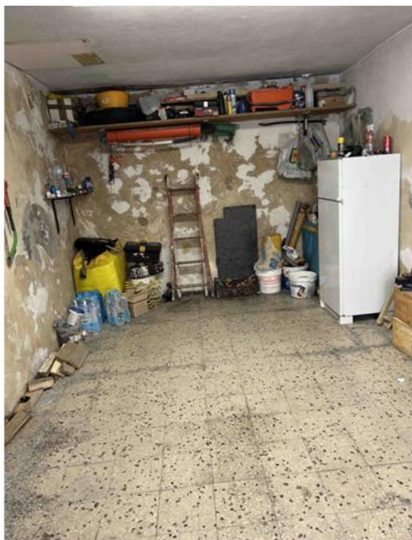
Foto n° 7 – Foto scattata all'interno del garage/box. La pavimentazione è in scaglietta di marmo mentre le pareti sono tutte intonacate. Si rilevano vistose tracce di umidità di risalita.
