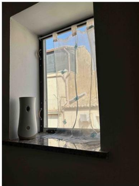
Foto n° 42 – Foto scattata all'infisso in ferro realizzato nel vano cucina che consente l'aerazione e l'illuminazione del vano cucina.
