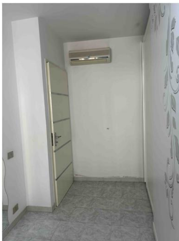
Foto n° 14 – Foto scattata nella prima camera che si trova al piano terra. La pavimentazione è in gres porcellanato e le porte sono in legno bianco laccato. E' presente un climatizzatore. Ottime le condizioni generali.
