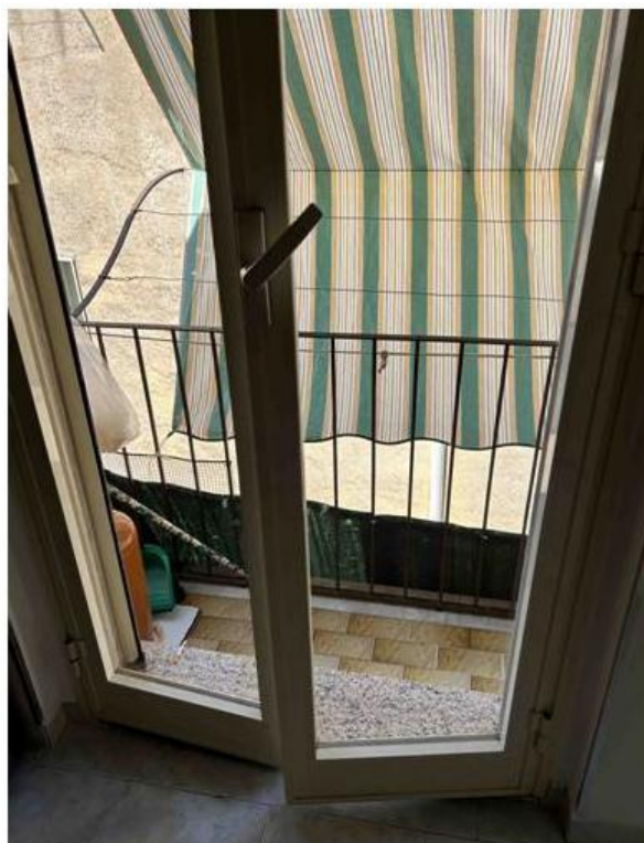
Foto n° 37 – Foto scattata all’infisso a due ante in alluminio pre-verniciato che consente l’affaccio su via Polizzi.
