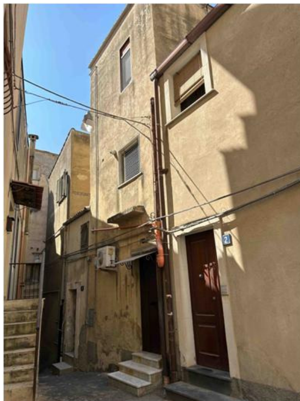
Foto n° 3 – Prospetto principale su via Leone. L'edificio, il cui ingresso è rialzato rispetto alla sede stradale, presenta un piano terra, un primo piano ed un secondo piano.
