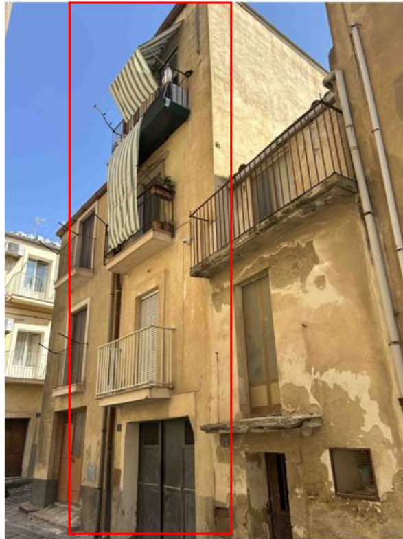
Foto n° 5 – Vista del prospetto su via Polizzi da cui si rilevano 4 elevazioni fuori terra. Discrete le condizioni generali della facciata che risulta intonacata e rifinita su tutti i lati.
