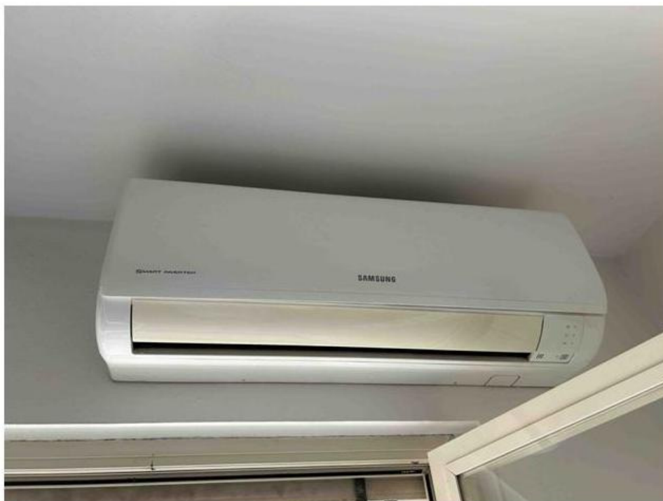
Foto n° 39 – Foto scattata al climatizzatore collocato nel vano cucina del secondo piano.
