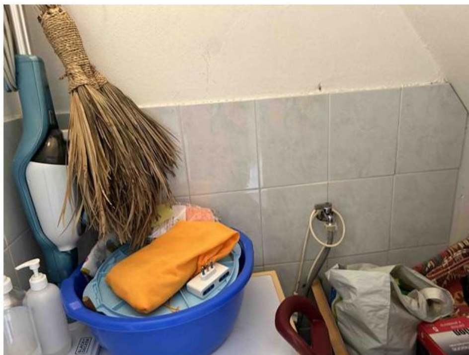
Foto n° 28 – Foto scattata all'interno della lavanderia. Tutte le pareti sono intonacate e tinteggiate mentre solo due pareti sono rivestite con piastrelle in pasta bianca delle dimensioni di cm. 20x 25 cm fino all'altezza di 1,00 metro.
