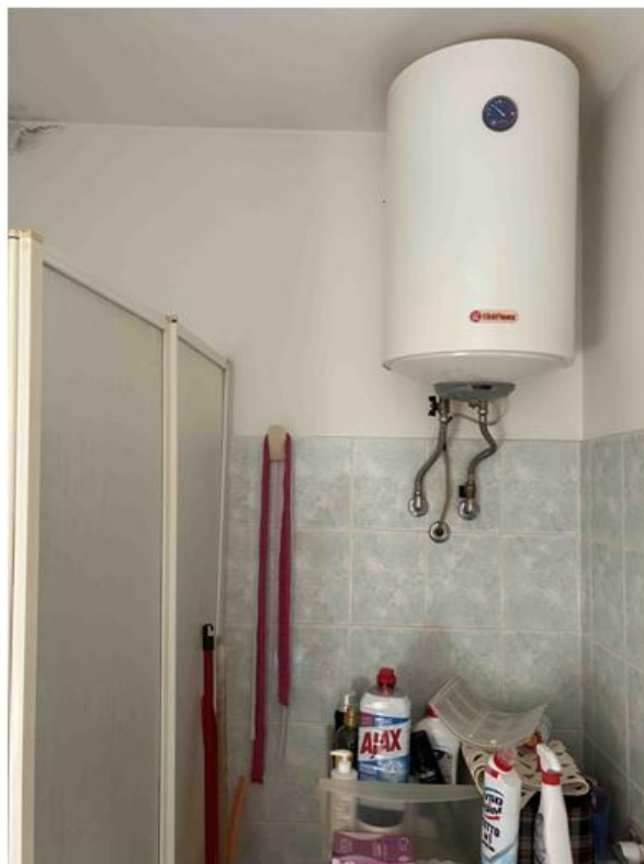
Foto n° 46 – Foto scattata allo scaldabagno da 80 litri ubicato all'interno del servizio igienico.
