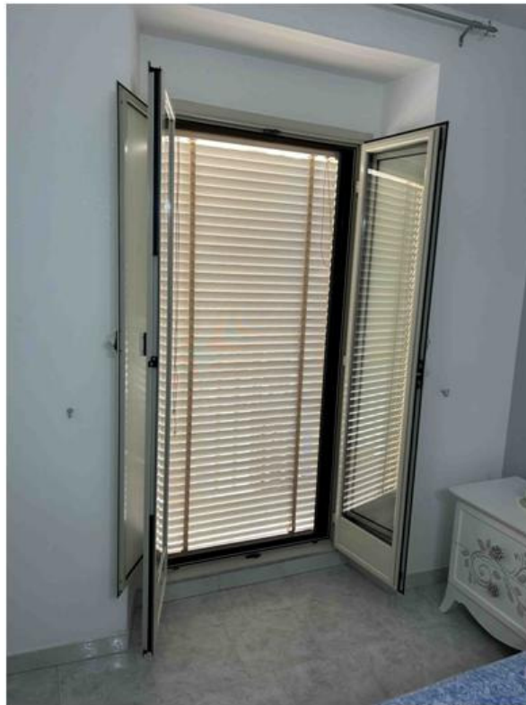
Foto n° 16 – Altra foto scattata nella prima camera che si trova al piano terra. Le pareti sono intonacate e tinteggiate con idropittura e l'infisso a due ante è in alluminio preverniciato dotato di scurette interne che consente l'affaccio su via Polizzi.
