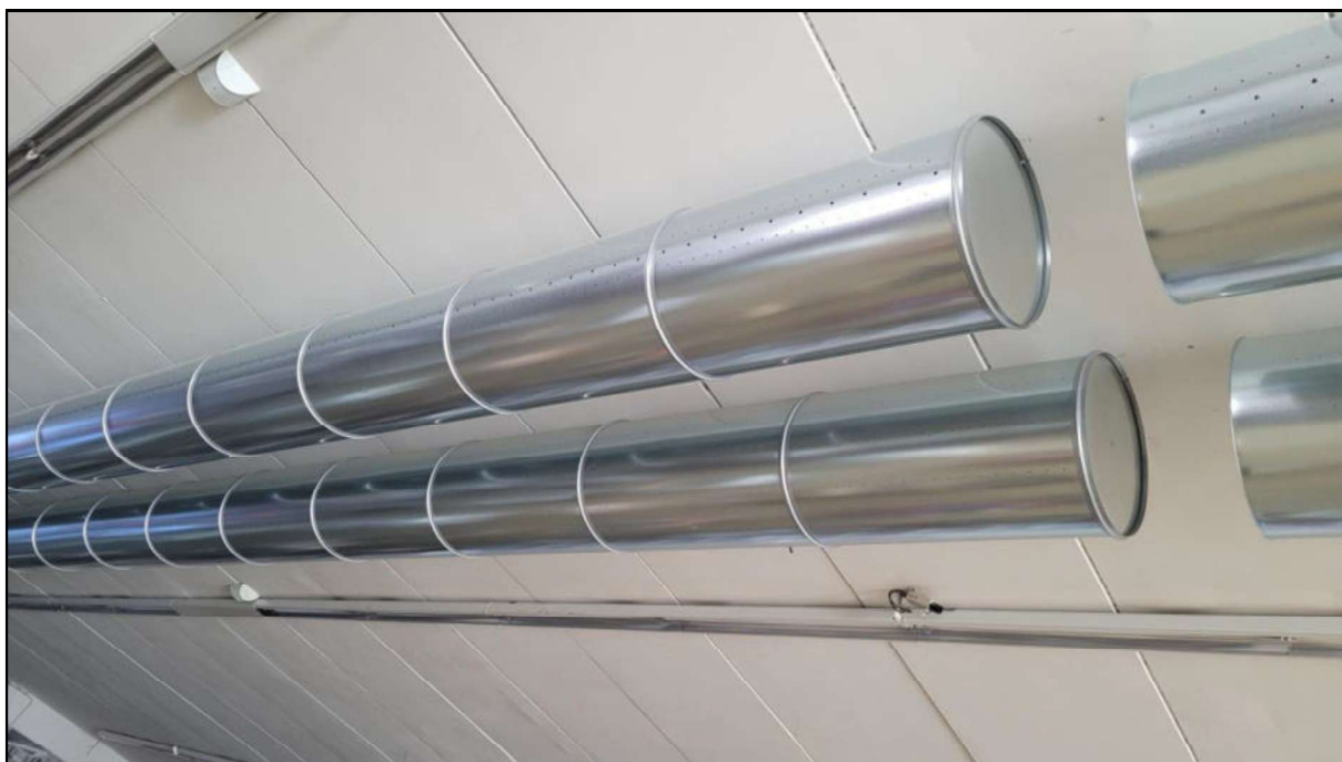
Foto 20: controsoffitto con diffusori aria microforati (impianto non funzionante)
