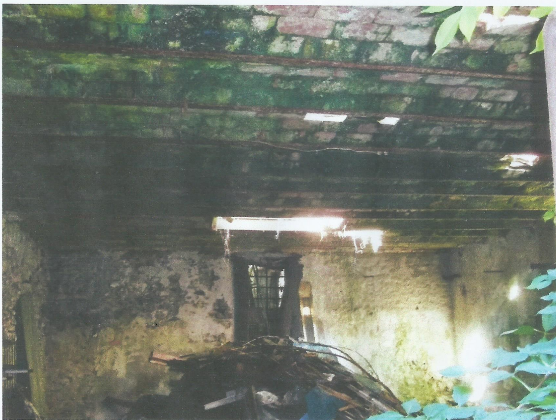
VISTA INTERNA PARTICOLARE SOLAIO PERICOLANTE
