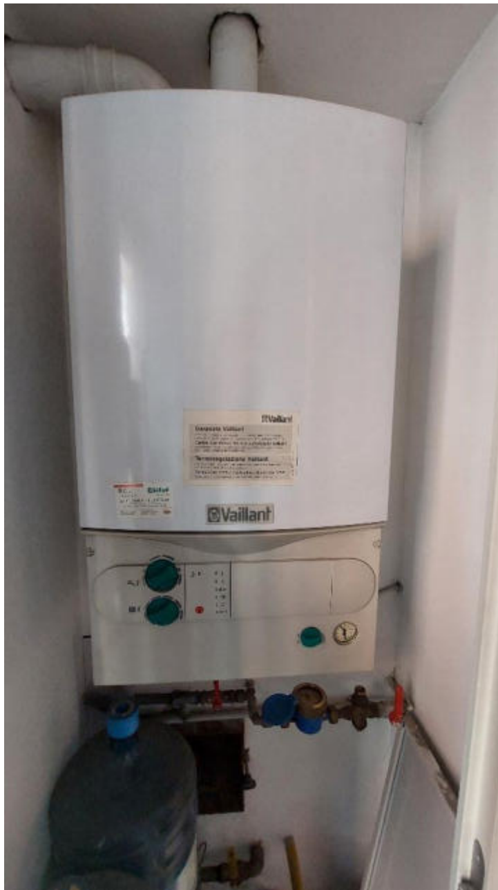
Particolare del generatore presente all'interno dell'unità immobiliare in apposita nicchia nel ripostiglio.
