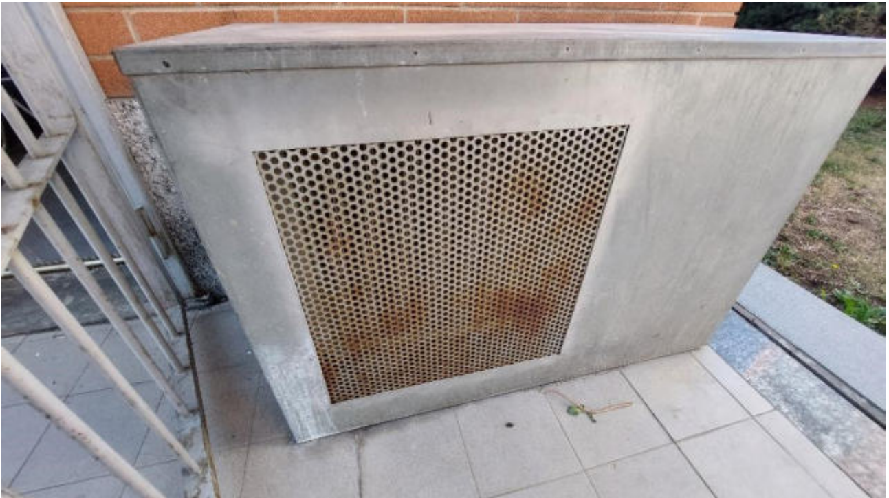
Particolare della gabbia contenente l'unità esterna della pompa di calore.
