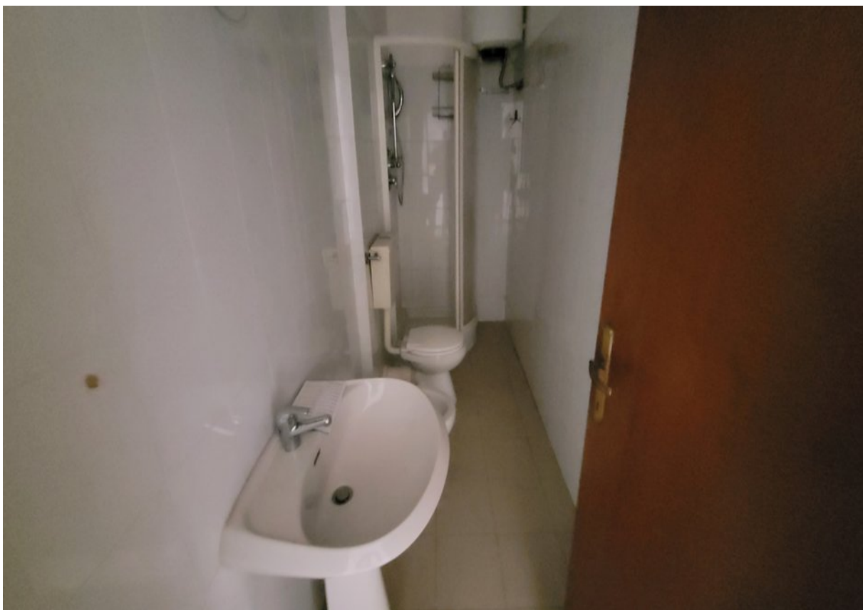
Vista wc doccia
