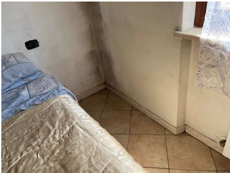
FOTO n°24 – LOTTO A, UNITÀ ABITATIVA 1°P, camera, muffa su parete
