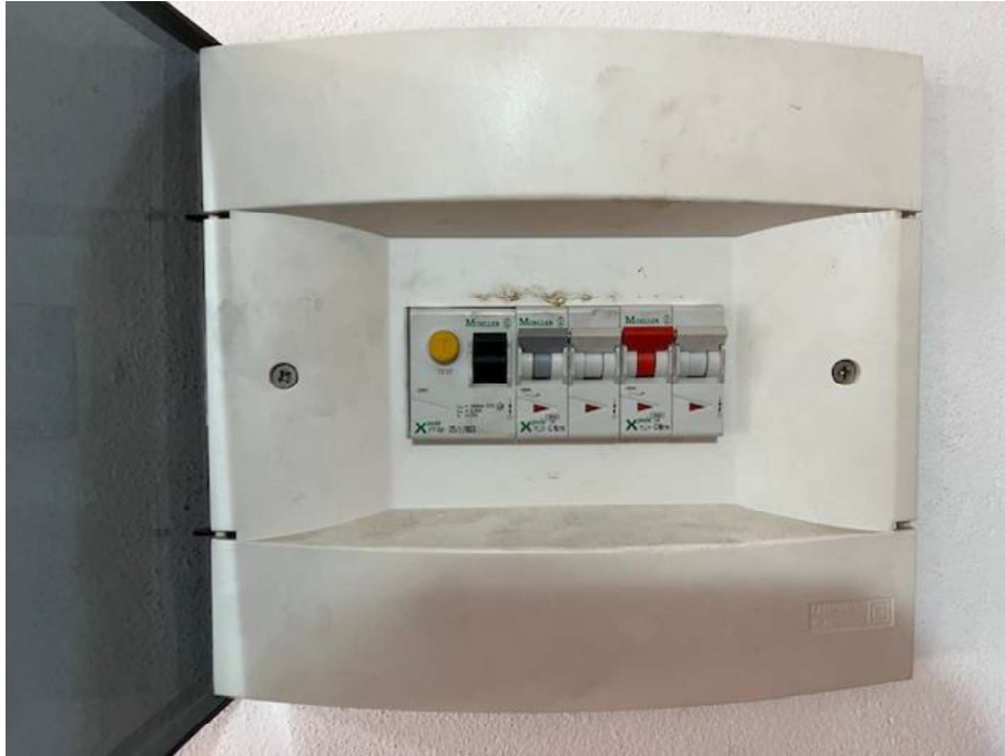
FOTO n°25 – LOTTO A, UNITÀ ABITATIVA 1°P, ingresso, interruttore generale
