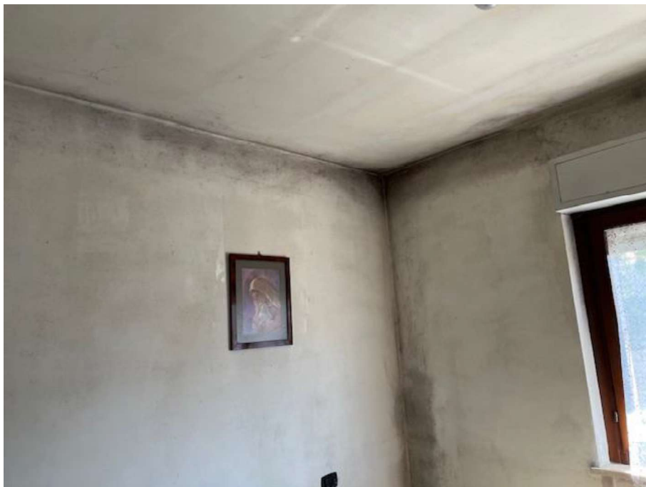
FOTO n°22 – LOTTO A, UNITÀ ABITATIVA 1°P, camera, muffa su parete
