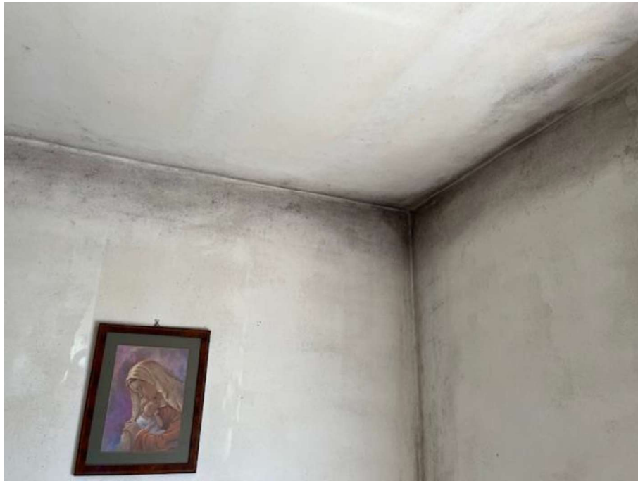
FOTO n°23 – LOTTO A, UNITÀ ABITATIVA 1°P, camera, muffa su parete
