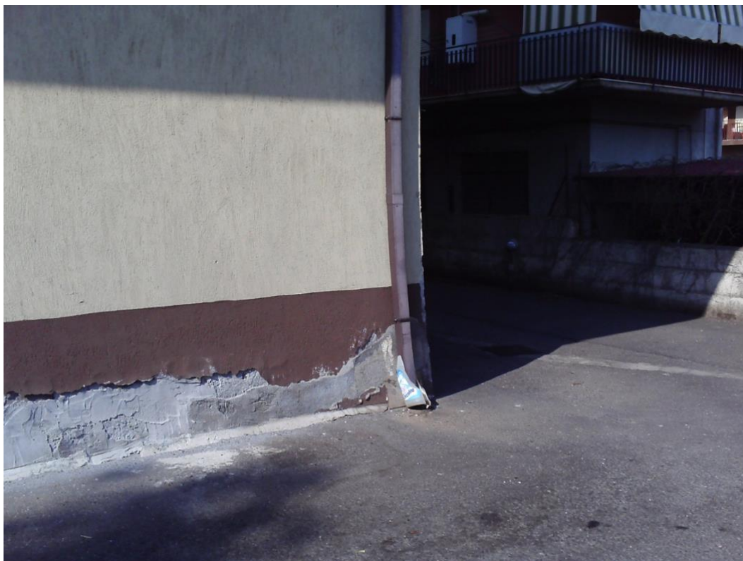
Particolare delle parti degradate dell'edificio
