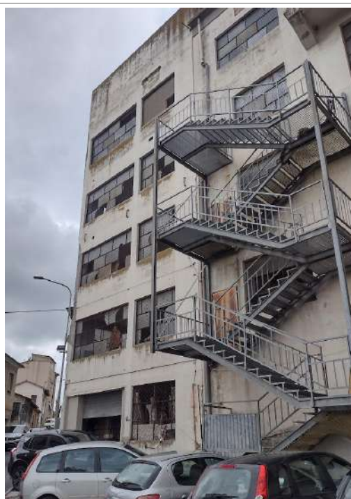
PART SCALA ESTERNA ANTINCENDIO
