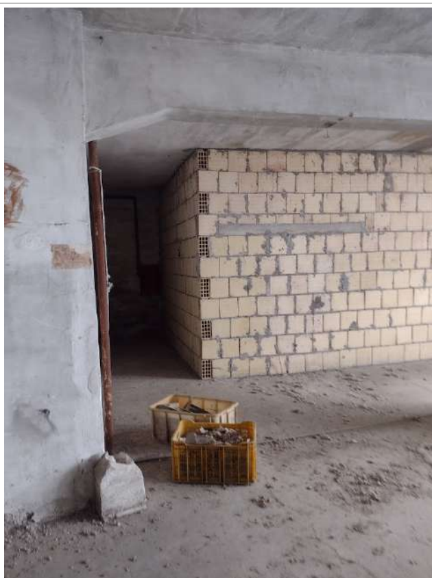
INTERNO SUB 47 LATO EST COMPARTIMENTATO
