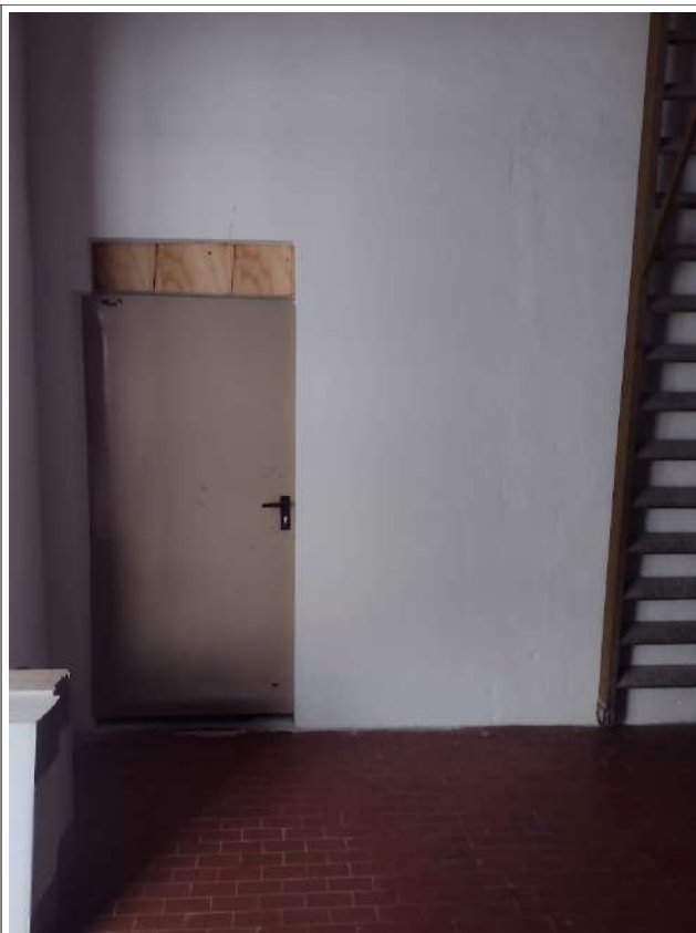
PORTA ANTINCENDIO COMPARTIMENTAZIONE SCALA CONDOMINIALE AL P.TERRA STRADA VIA CAVALLOTTI
