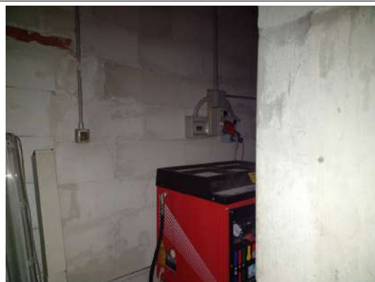
IMPIANTO SU PIANEROTTOLO CONDOMINIALE IN USO PRIVATO A CONDOMINO NON IDENTIFICATO
